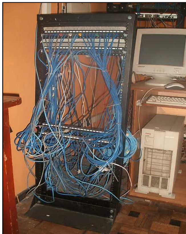
Figura 9: Rack de extensiones telefónicas.
