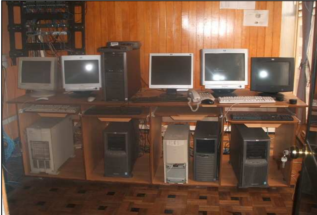
Figura 6: Cuarto de comunicaciones del GMT.
