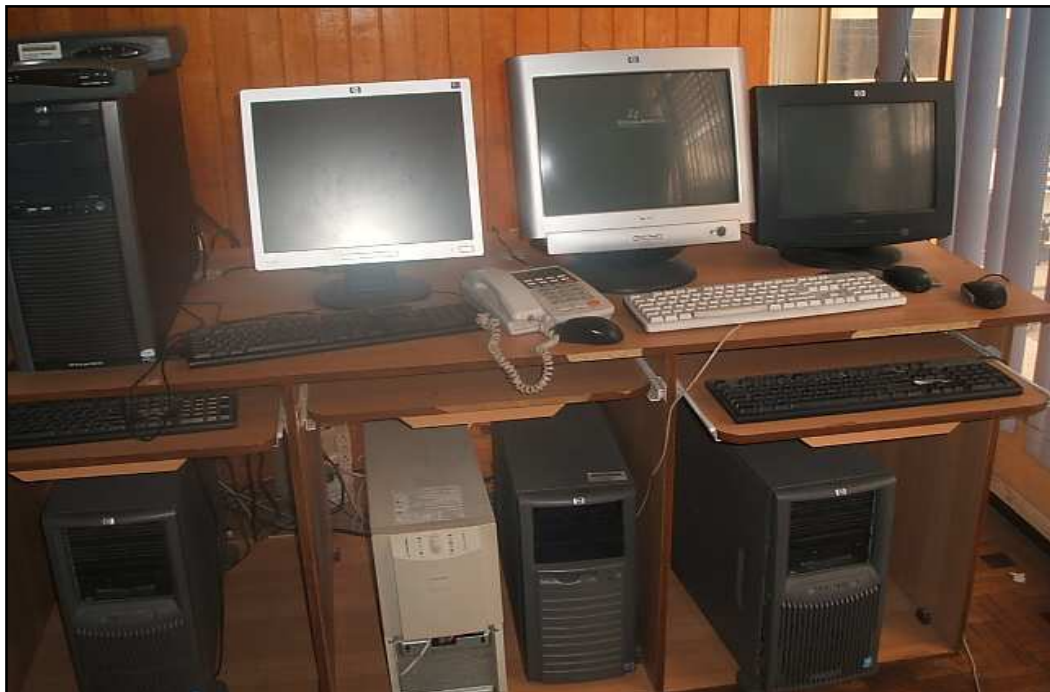
Figura 7: Servidores del cuarto de comunicaciones.
