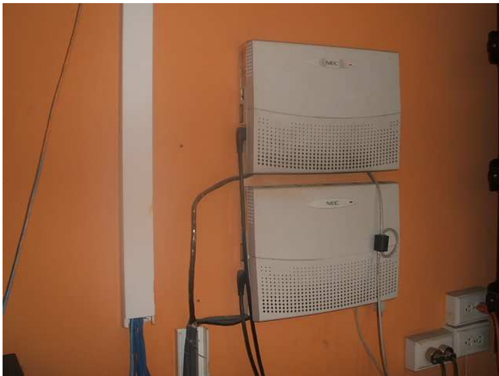
Figura 12: Centrales telefónicas NEC IP2AP-924M-KSU PABX
