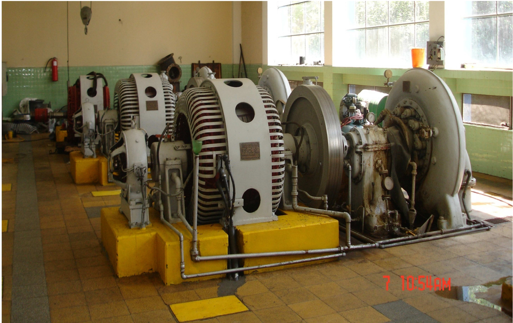
ANEXO 27. Grupo Generador # 3 De la Central Península|
