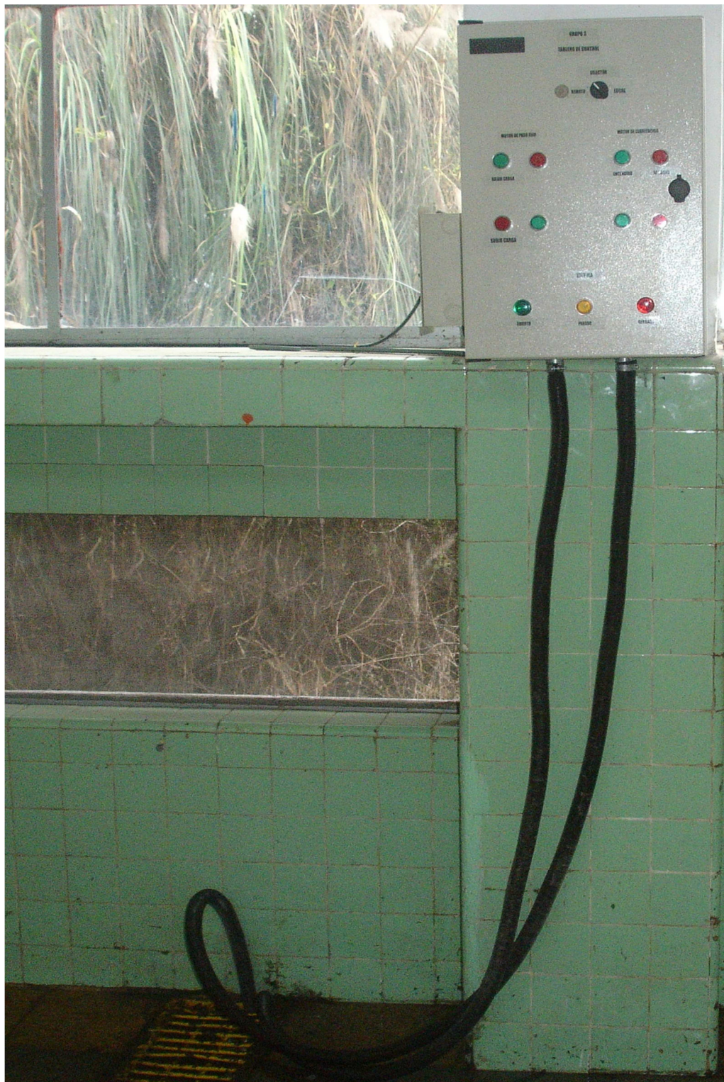
ANEXO 22. Tablero de Control Industrial instalado para el Grupo # 3 en la Central Península.
