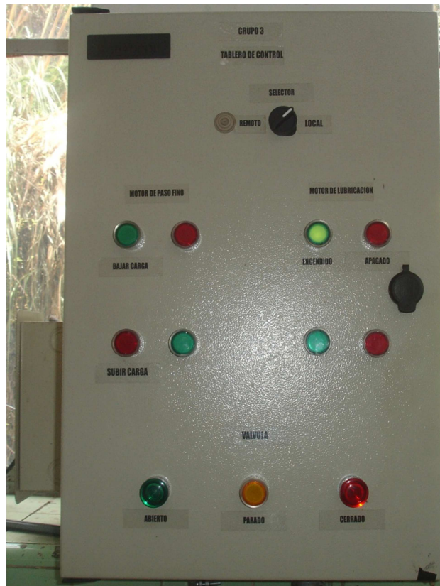
ANEXO 20. Vista frontal del Tablero de Control Industrial instalado para el Grupo # 3 en la Central Península.
