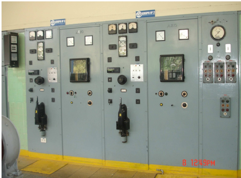
ANEXO 26. Tablero de Control General de los Grupos Generadores de la central Península.
