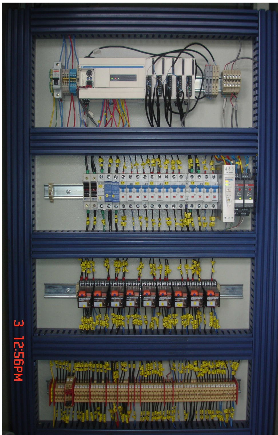
ANEXO 13. Vista Interna del Tablero del PLC.
