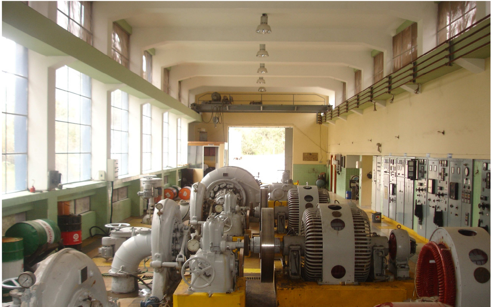
ANEXO 10. Grupos Generadores de la Central la Península.
