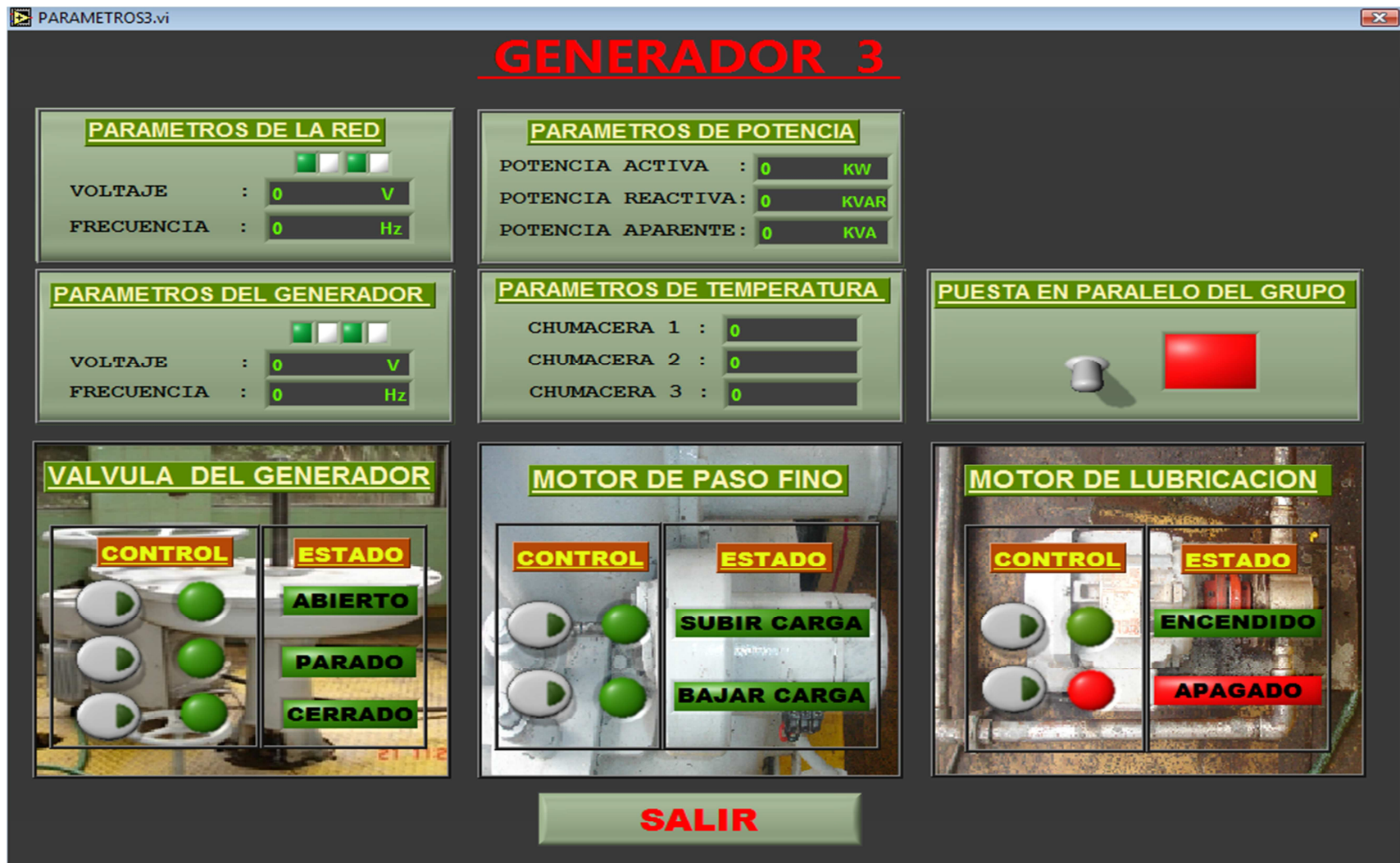
Fig 58. Panel frontal. Modo de operación Manual Grupo Generador #3.
