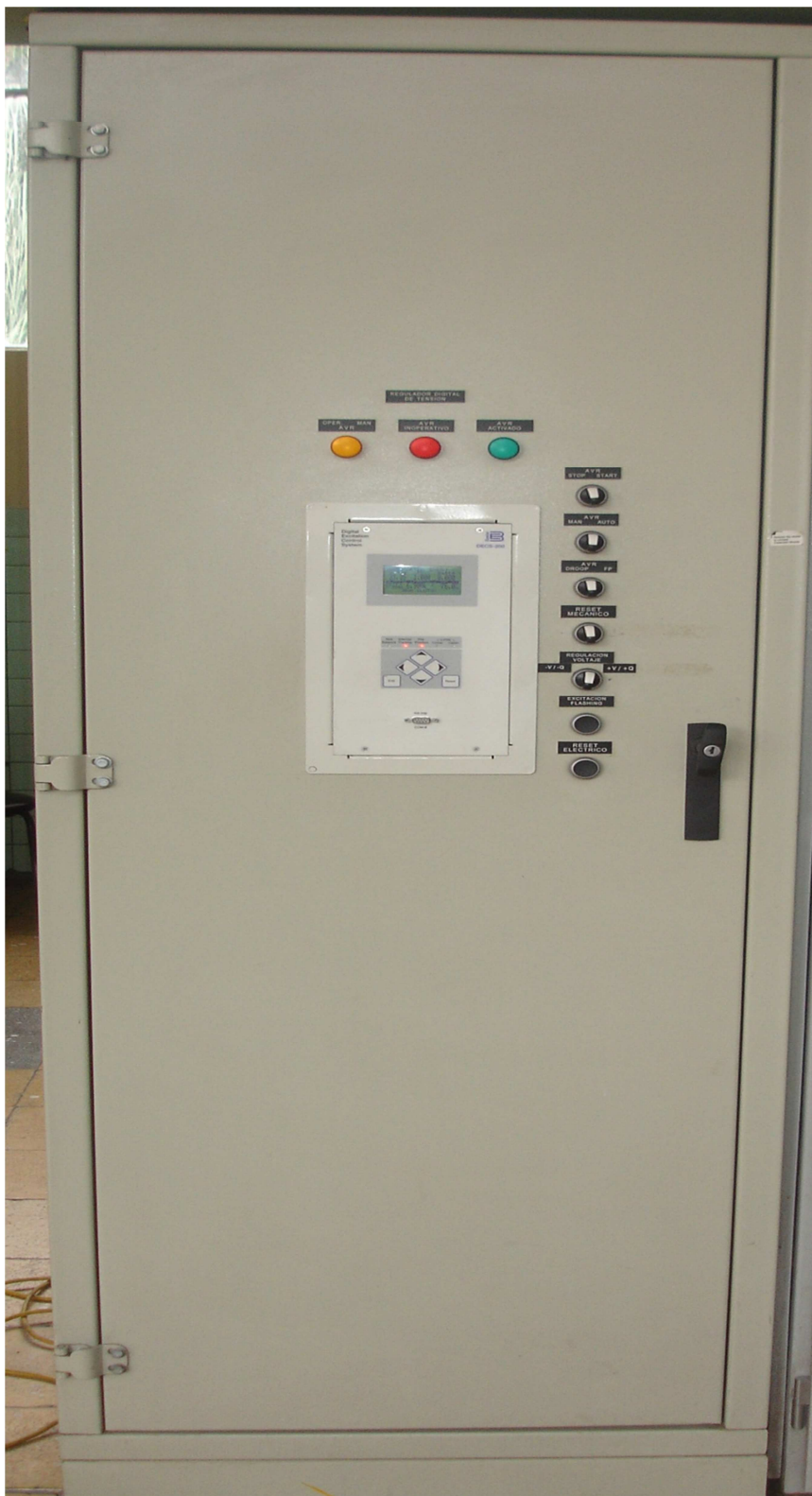
ANEXO 12. Vista Frontal del Tablero del PLC.
