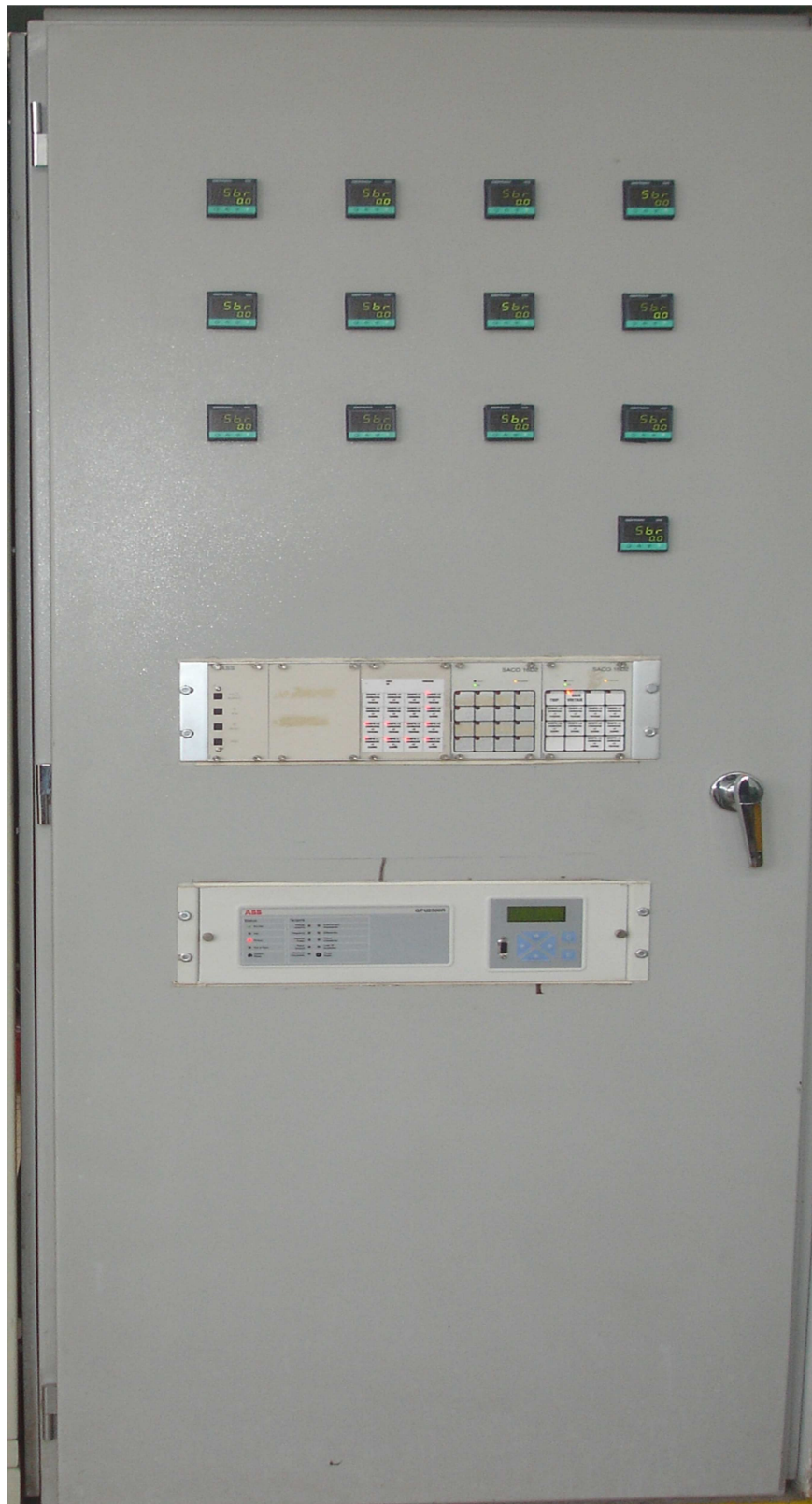
ANEXO 14. Vista Frontal del Tablero de los sensores de temperatura.
