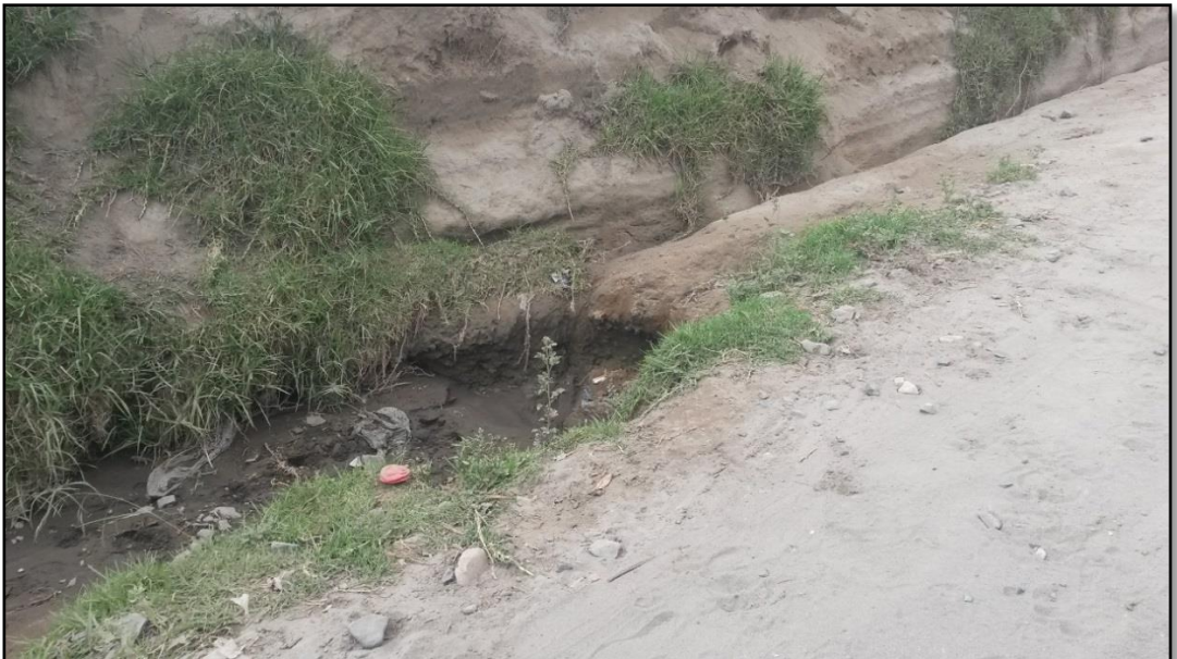
Fotografía 4: Socavación de la vía.
