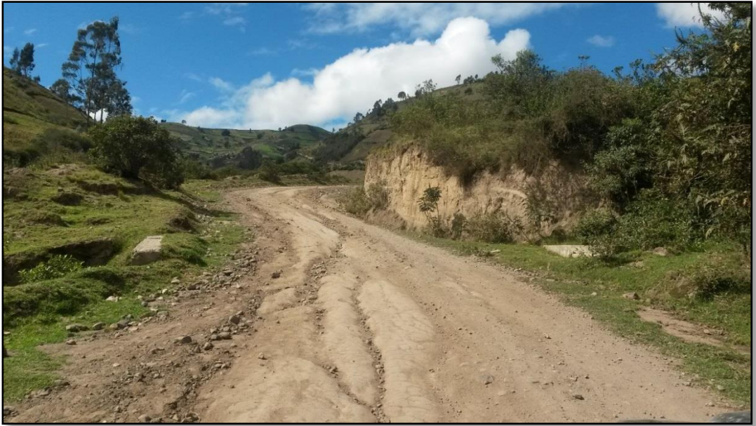
Fotografía 11: Estado actual de la vía.
