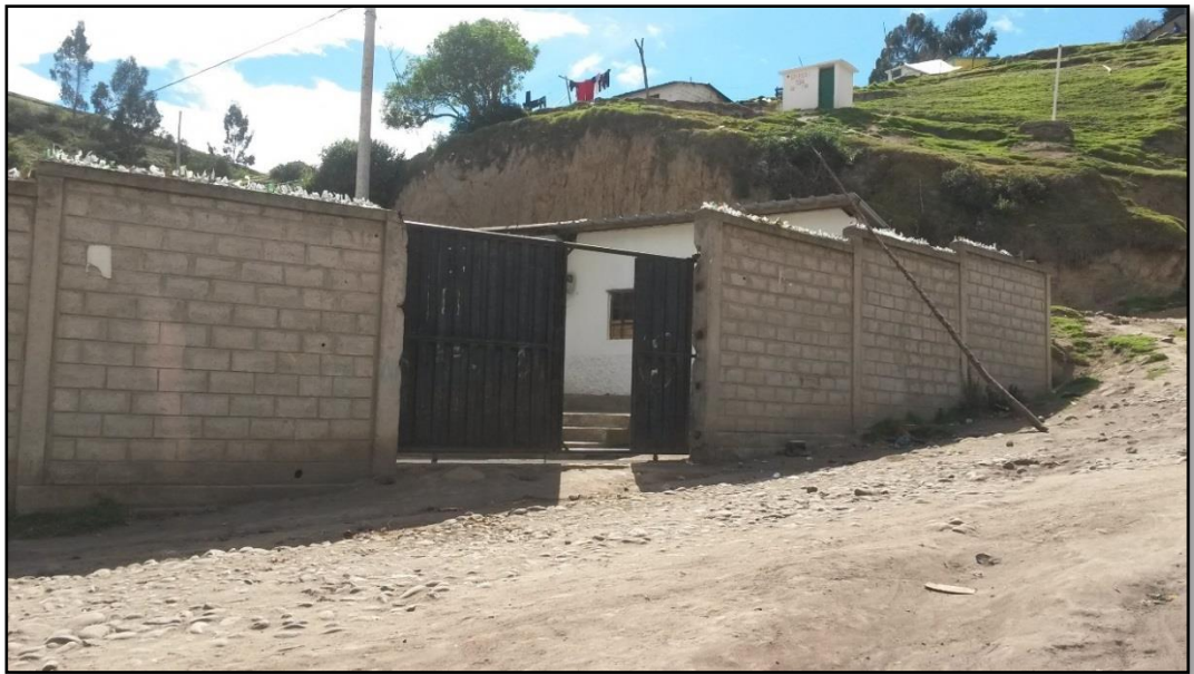
Fotografía 19: Tramo final de la vía (empedrado en mal estado).
