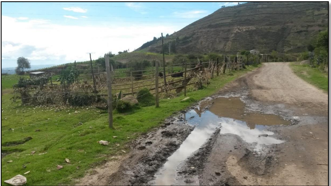
Fotografía 8: Estancamientos de aguas lluvias.
