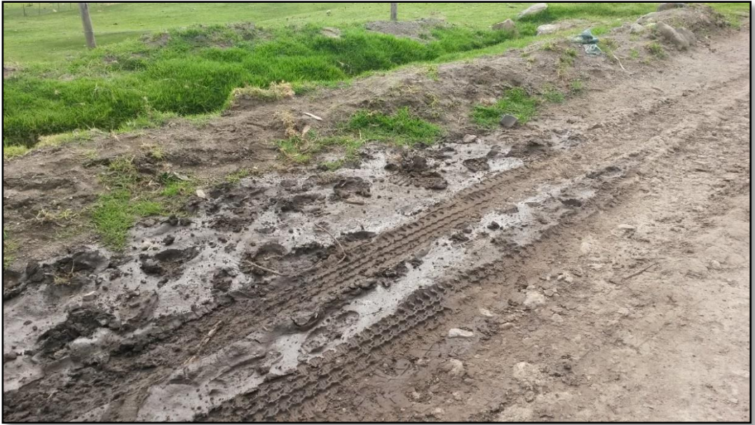
Fotografía 7: Lodazales en la vía.
