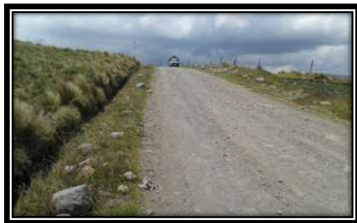
Imagen 2.- La falta de cunetas provocan que la lluvia deteriore la vía.
