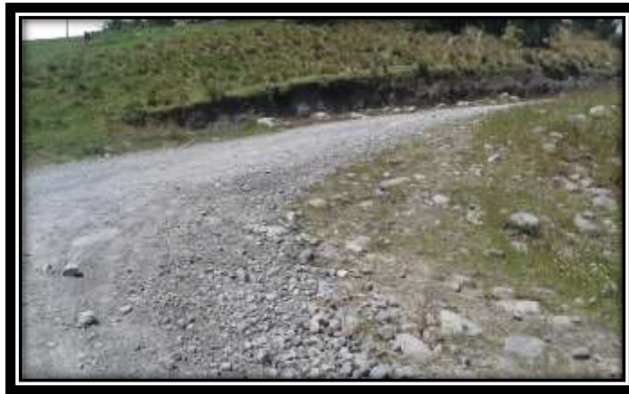
Imagen 1.- Vía en estudio en mal estado
