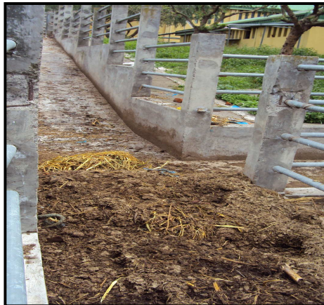
FOTO 4.1 Abono seco acumulado en la parte posterior del camal sanitario
