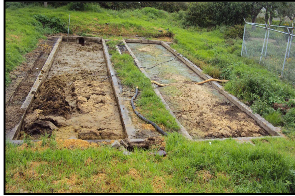
FOTO 4.10 Tanques Imhoff con exceso de residuos sólidos (estiércol, grasa, pelos, y rumen), están ubicados en la parte posterior del camal
