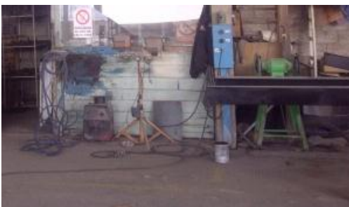
Fotografías 21: Instalaciones eléctricas Elaborado por: Alexandra Fiallos
