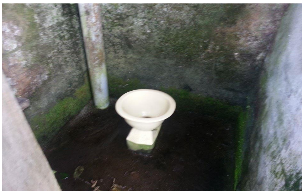
Estado actual de los aparatos sanitarios en el sector
