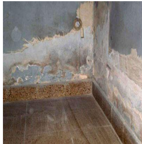
GRÁFICO N.-6 Pared de mampostería con humedad.
