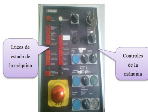
Figura 32. Panel de Operador.
