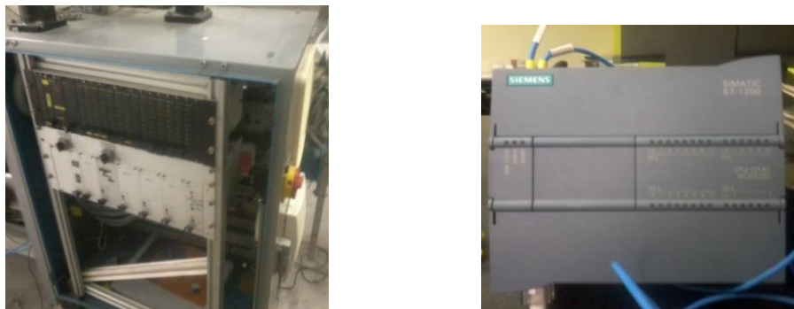
Figura 137. Cambio del PLC antiguo por el de SIEMENS.
