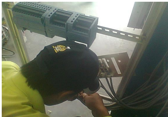
Figura 141. Conexión de las entradas y salidas al PLC nuevo.
