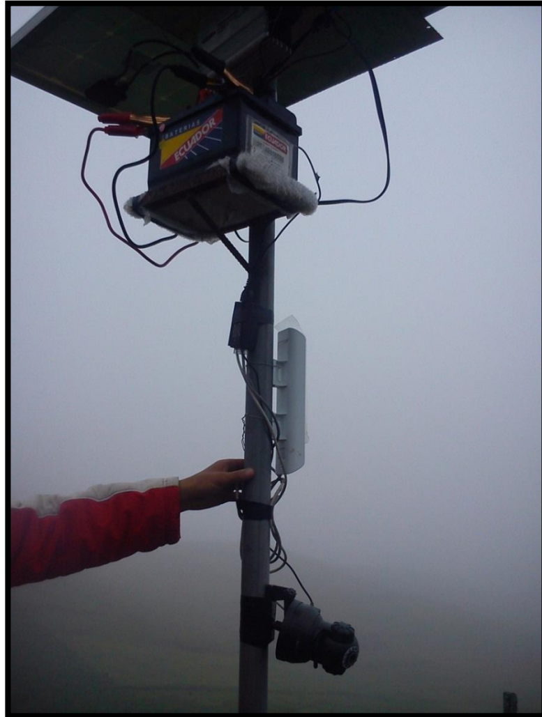
Figura 4.50 Conexión cámara ip
