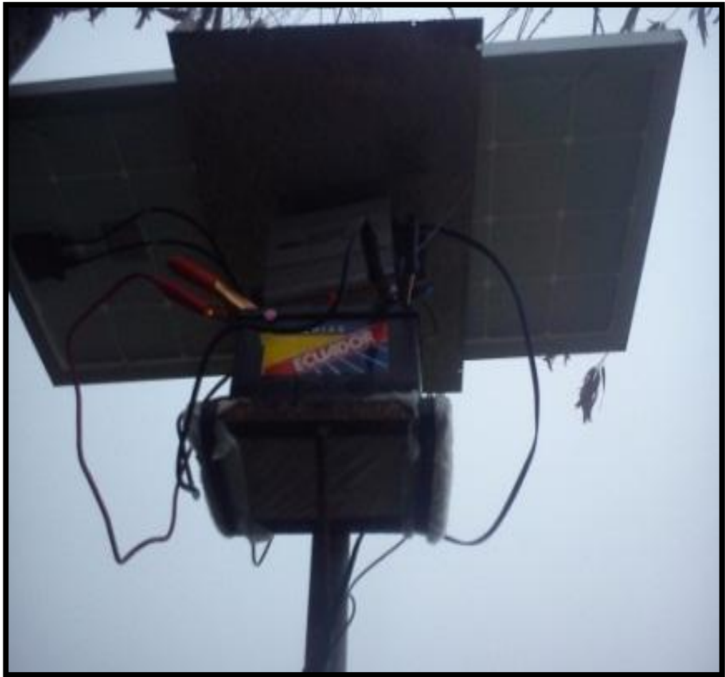
Figura 4.48 Conexión del panel solar Fuente: Realizado por el investigador
