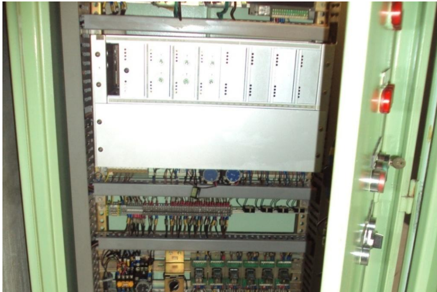
Figura 4.46: Interior del armario del sistema de limpieza
