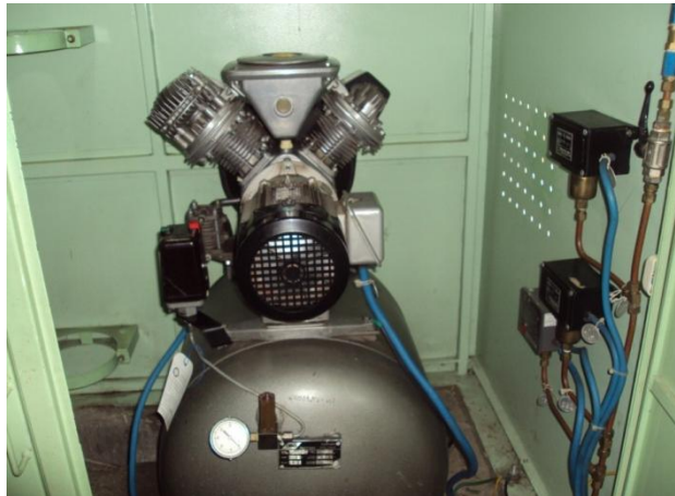
Figura 4.40: Motocompresor del sistema
