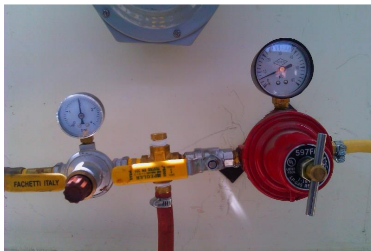
Fig. 3.5: Reguladores de alta y baja presión de gas
