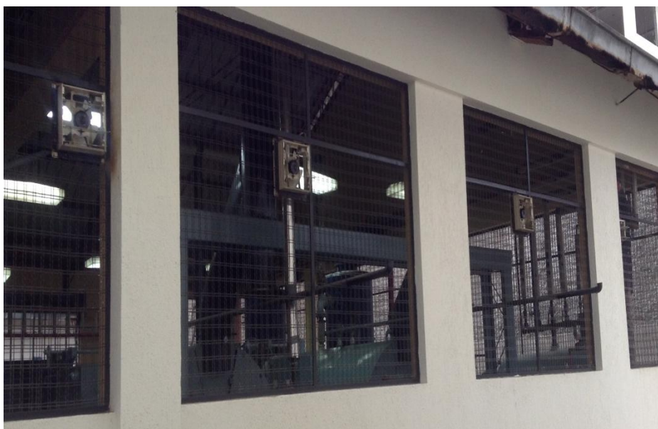
Foto 6.2 Extractores instalados (Fuente: Egdo. César Robalino)
