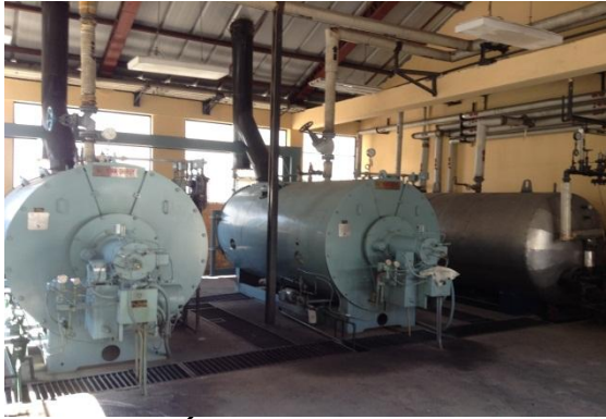
Área de calderas
