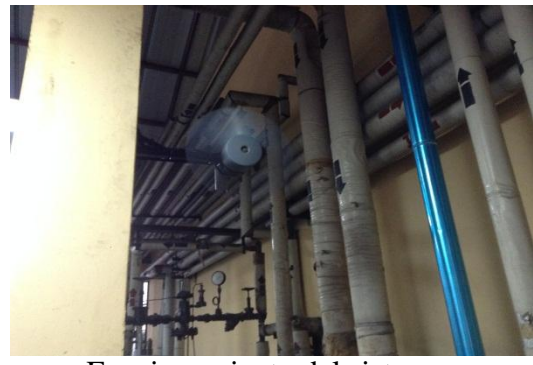
Funcionamiento del sistema
