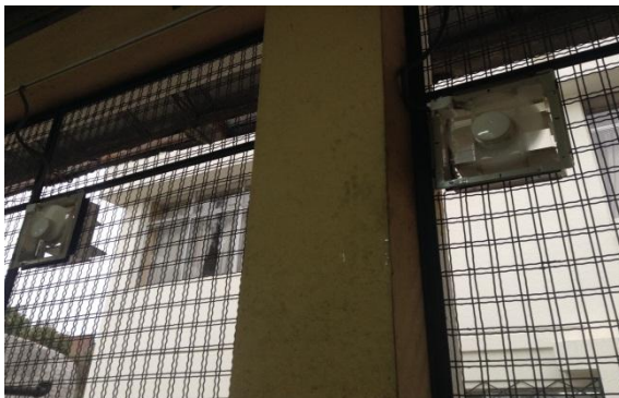
Funcionamiento del sistema
