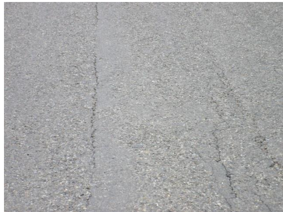
Presencia de fisuras longitudinales
