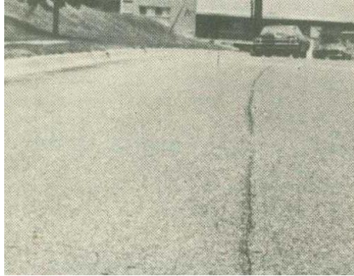
Figura 11. Grietas de juntas de carril
