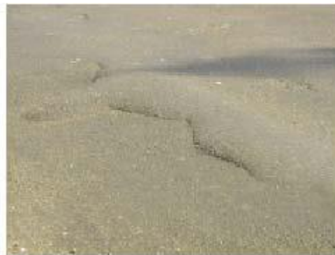
Figura 21. Ondulaciones y desplazamientos
