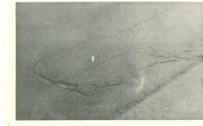
Figura 13. Grietas de deslizamiento
