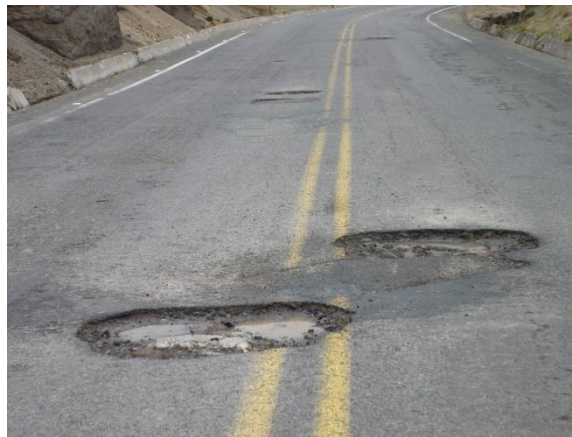
Baches en la vía de estudio
