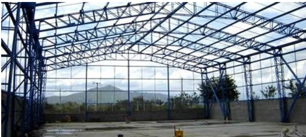
Figura. 2.4.6.1.3. Estructura de acero grande claro [37]: DRY WORK (2009), Lima-Perú, recuperado de www.drywork.com/servicios.html
