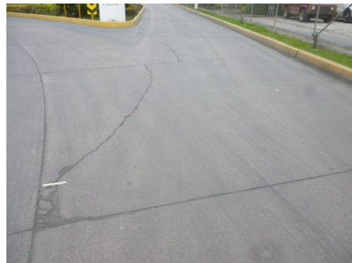
Rotura de esquina abscisa: 0+068,87
