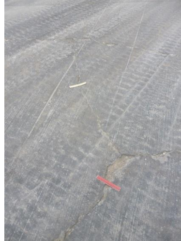
Fisura longitudinal abscisa: 0+170
