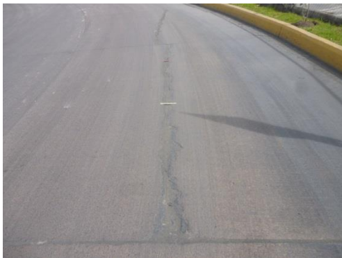
Fisura longitudinal abscisa: 0+038
