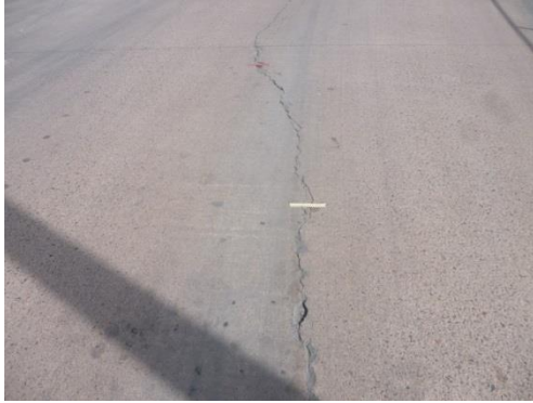
Fisura longitudinal abscisa: 0+021
