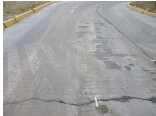
Fisura transv. y long. abscisa: 0+416
