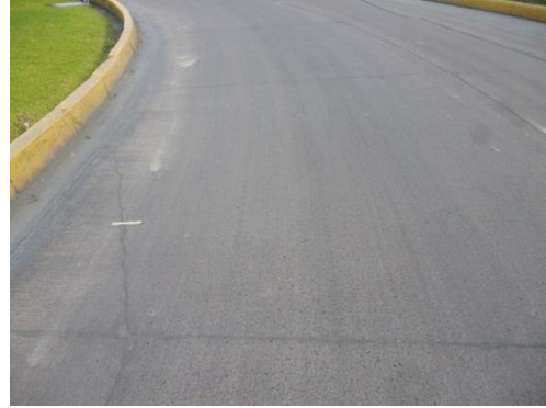
Rotura de esquina abscisa: 0+036
