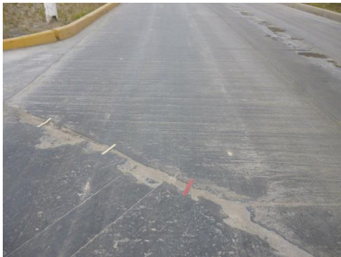
Fisura diagonal abscisa: 0+350
