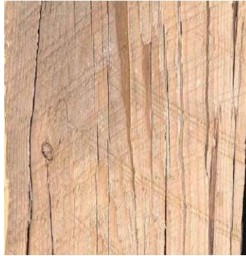
FIGURA N° 2.29. Grietas y rajaduras.
