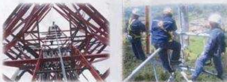
Plataformas de trabajo en la zona superior de la torre o extensiones de tubo.
