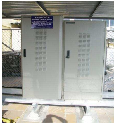
Rack de Baterias
