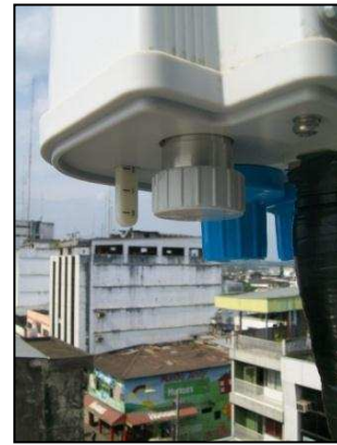
Figura 6.20: Til Eléctrico 2°(Después)
