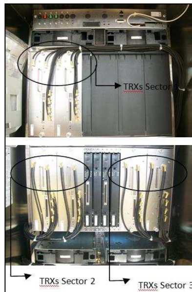
Figura 6.35: BTS y TRXs del Sistema Radiante
