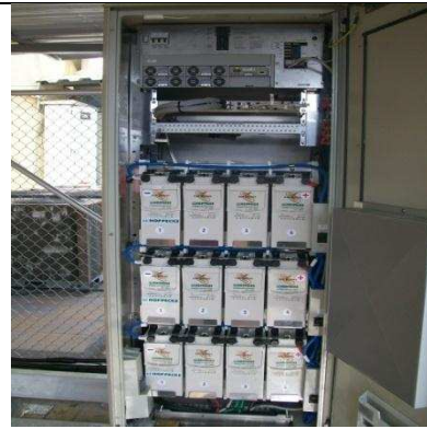
Banco de Baterias
