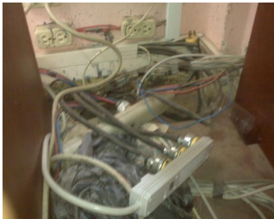
Fig. 1A-7 Tomas de Energía
