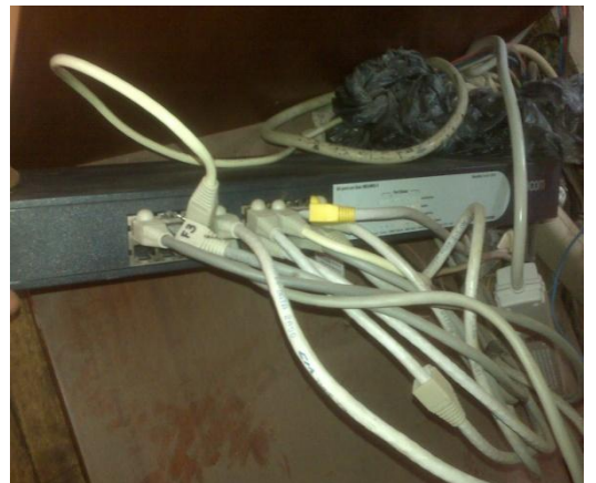
Fig. 1A-8 Switch pegado sobre el piso
