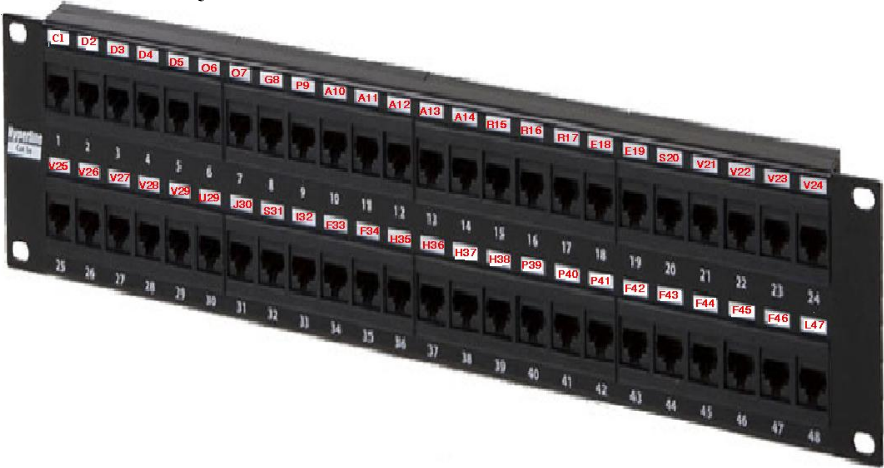
Fig. 1A-11 Etiquetamiento de los puntos de red en el Patch panel 1
