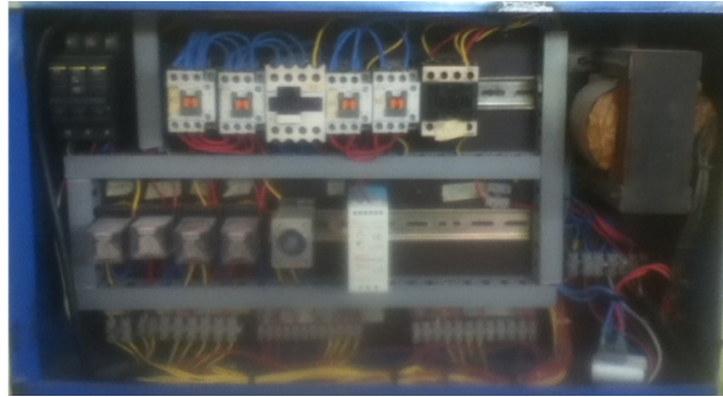
Figura 6.91. Tablero de control terminado
