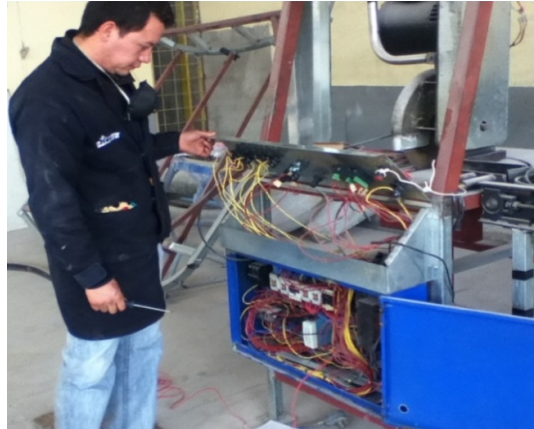
Figura 6.96. Pruebas de funcionamiento del Sistema de Control Eléctrico
