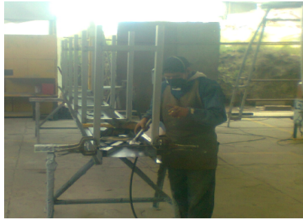
Figura 6.75. Estructura soporte de sistema de transporte
