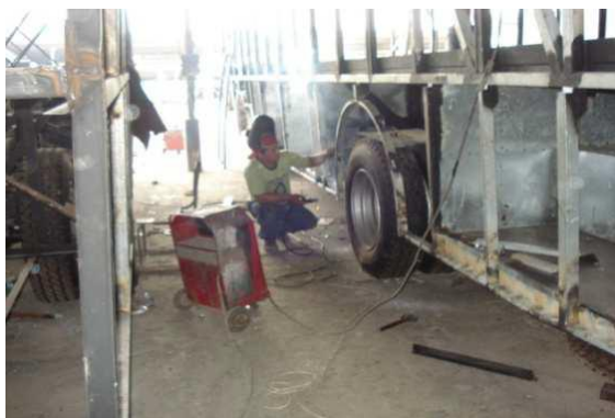
Figura N°18: Condiciones de seguridad en la empresa.
