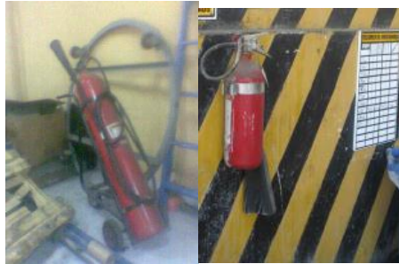
Figura N°31: Deficiencia de extintores.
