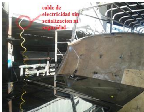
Figura N°29: instalaciones eléctricas sin seguridad.
