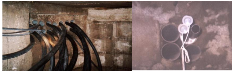
Figura 6.23: Ducterías Fuente: Investigador
