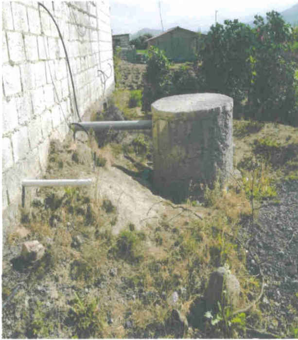
Utilización de pozos sépticos o pozos ciegos en vez de alcantarillado
