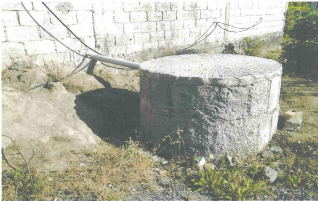
Pozo séptico hecho por el dueño del inmueble por falta de alcantarillado
