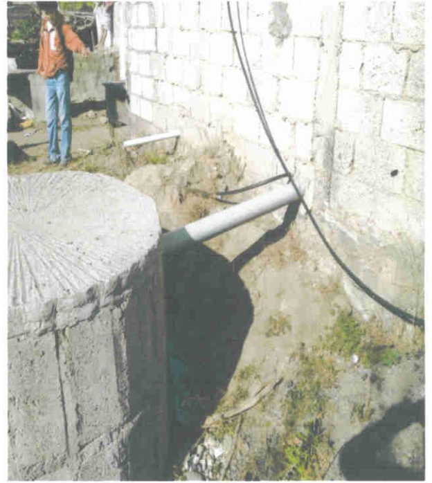
Utilización de pozos sépticos o pozos ciegos en vez de alcantarillado
