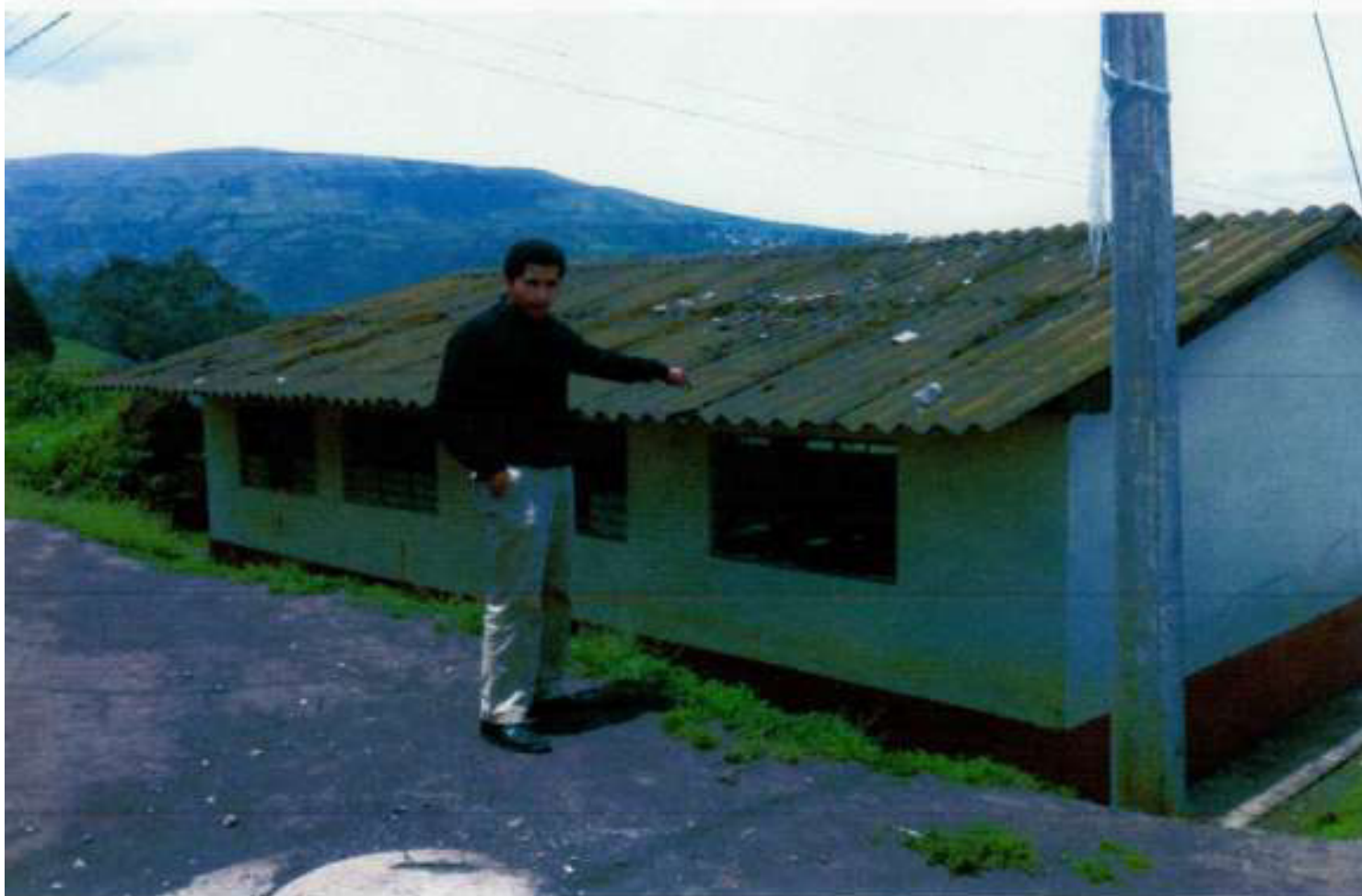
Fachada deteriorada de la escuela
