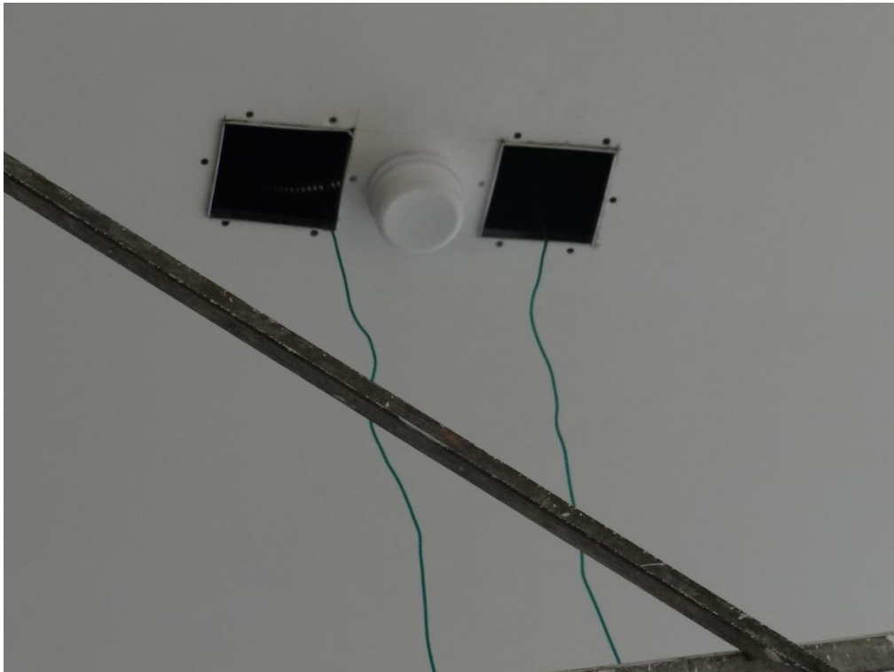
Comunicación inalámbrica parte IV: Módulo Zigbee colocado correctamente
