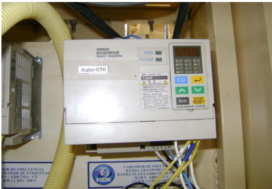
Anexo B2: Instalación y Cableado de la Máquina Etiquetadora
