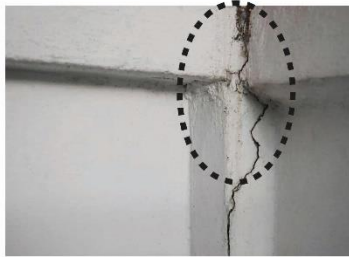
GRIETA EN ELEMENTOS ESTRUCTURALES
