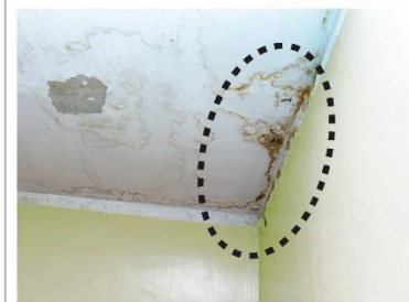
HUMEDAD EN PAREDES
