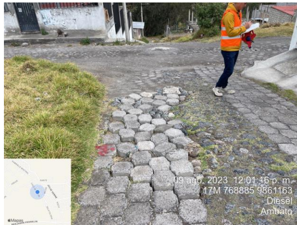
Ilustración N° 38 Pérdida de arena Zona 35 Techo Propio – Tiuhua (Ambato, Tungurahua)
