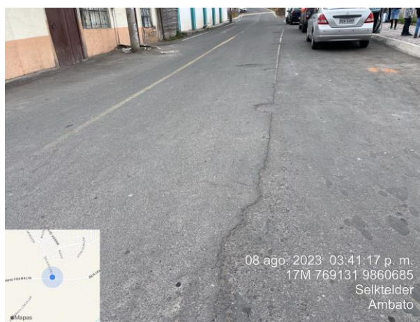
Ilustración N° 13 Grieta de Borde Zona 35 Techo Propio – Tiuhua (Ambato, Tungurahua)
