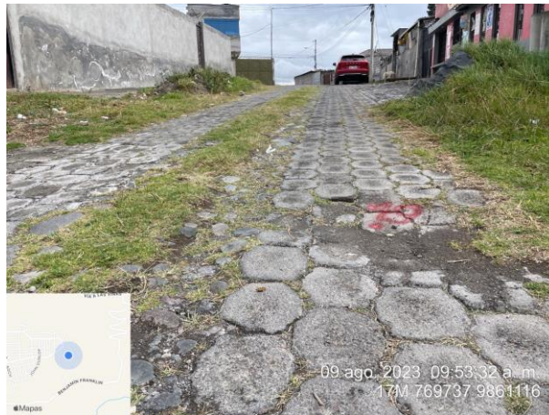
Ilustración N° 32 Ahuellamiento Zona 35 Techo Propio – Tiuhua (Ambato, Tungurahua)
