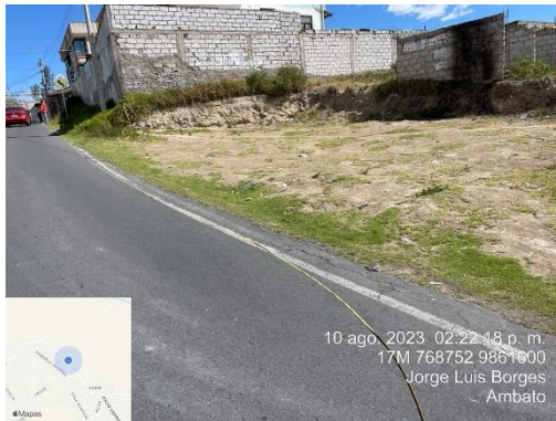
Fotografía 9 Medición de Elementos Faltantes
