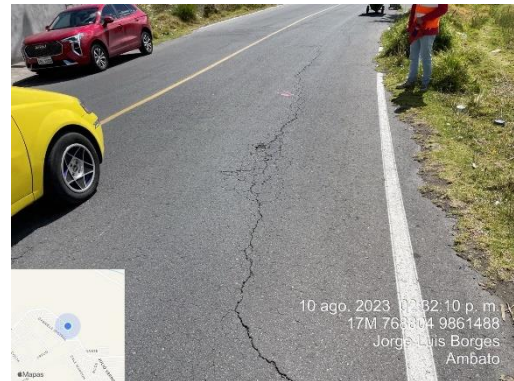
Fotografía 10 Falla Grieta Longitudinal
