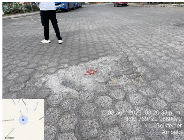
Ilustración N° 41 Fracturamiento Zona 35 Techo Propio – Tiuhua (Ambato, Tungurahua)
