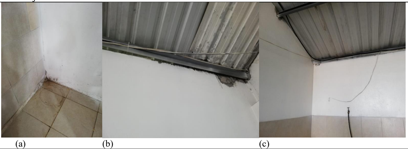
(a) (b) (c) La unión de las paredes con el piso y techo no son cóncavas (a, b), además, de que las paredes están pintadas, pero no es pintura epóxica. El piso está recubierto con baldosa. Existe presencia de cables colgantes que no cuenta con protección (canaletas) (c).
