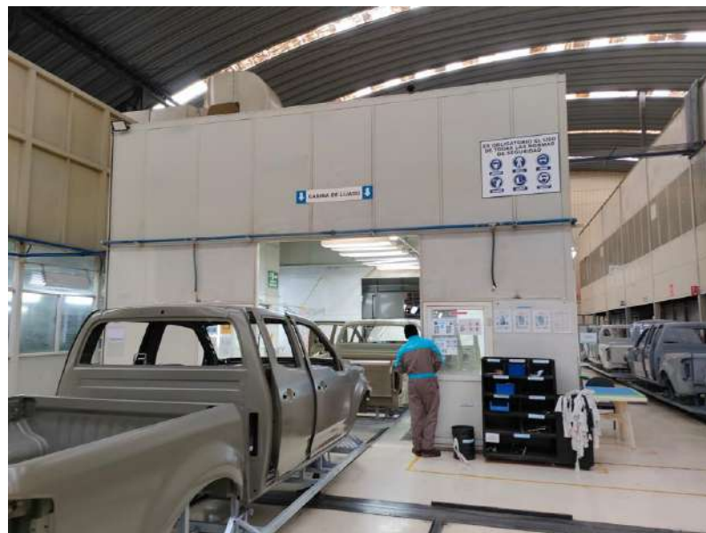
Figura 22. Cabina de lijado adjunta (existente).
