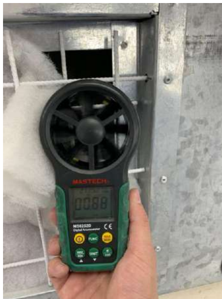
Figura 43. Velocidad del aire en los filtros de extracción en el interior de la cabina.
