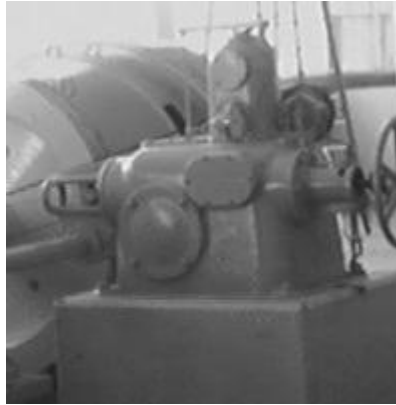
Figura 4.4 Regulador de Velocidad para el grupo generador 4
