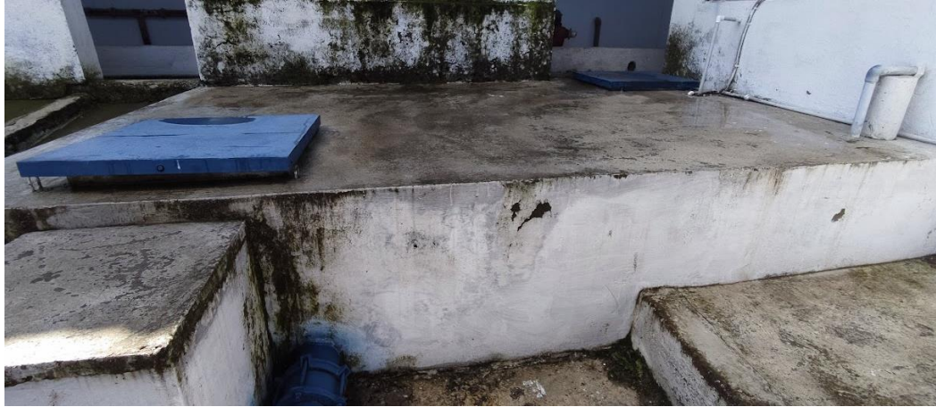
Figura 16: Cámara de Mezcla.
