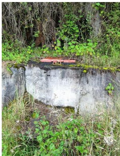
Figura 23: Captación Dañada (seca) de la PTAP “El Mirador”.
