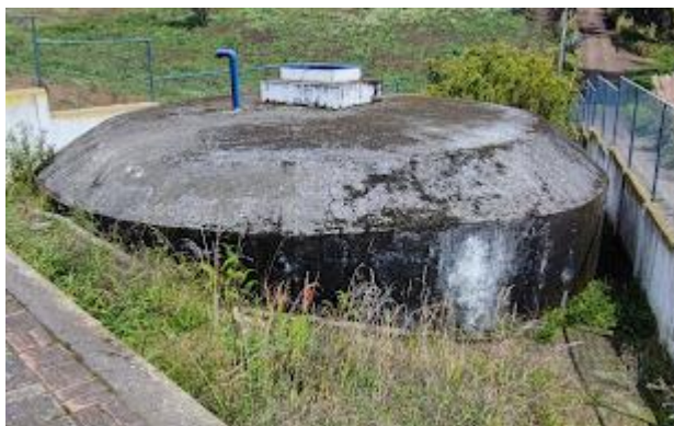
Figura 15: Tanque de Almacenaje (200m 3 ).
