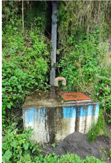
Figura 21: Captación Secundaria de la PTAP “El Mirador”.
