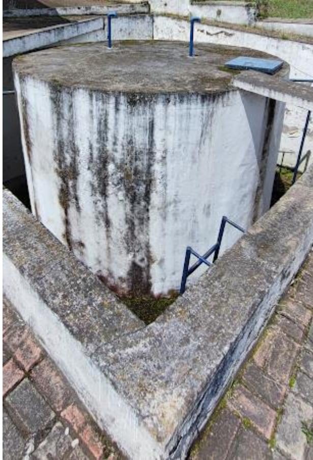
Figura 14: Tanque de Almacenaje (50m 3 ).
