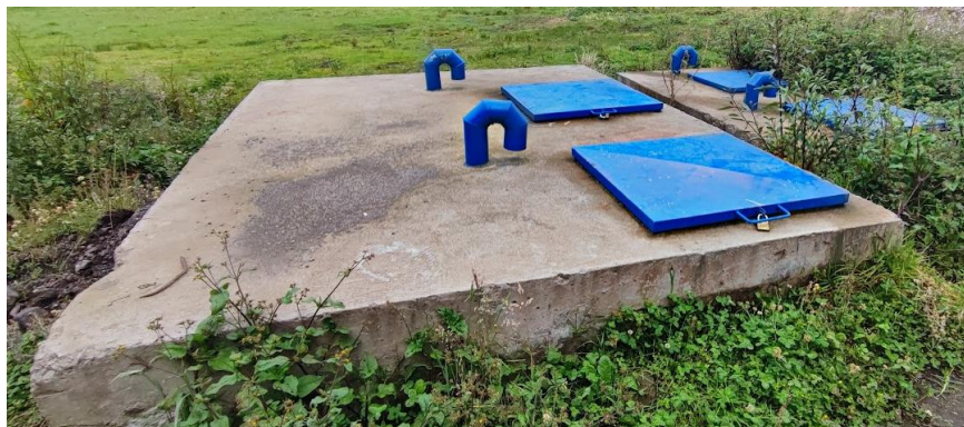
Figura 22: Captación Terciaria de la PTAP “El Mirador”.
