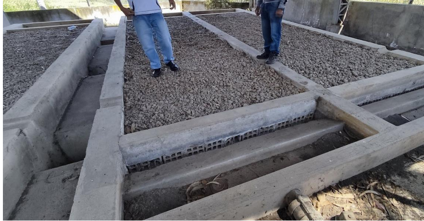
Figura 18: Filtros de grava zona previa PTAP “El Mirador”.
