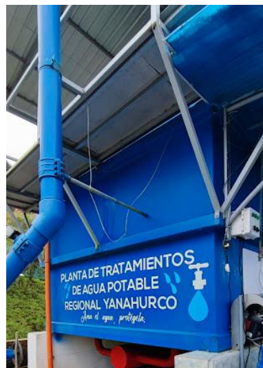
Figura 28: Planta de Tratamientos de Agua Potable Regional de Yanahurco.
