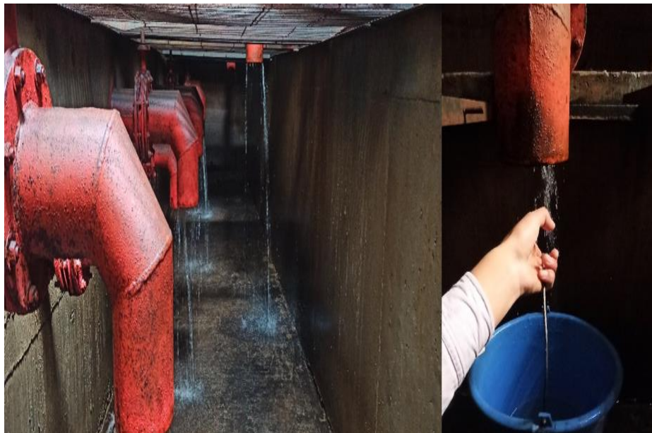
Figura 26: Medición de las fugas de caudal por estado de las válvulas
