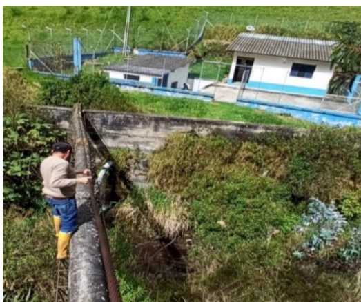
Figura 30: Estación de bombeo Huayrapata Fuente: Autor.
