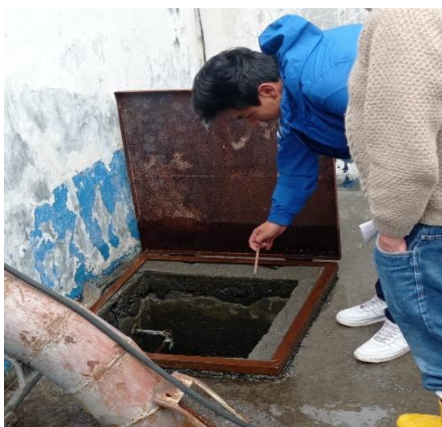
Figura 32: Reboce de agua proveniente de las bombas Fuente: Autor.
