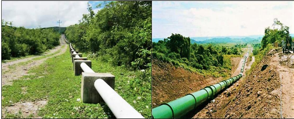
Figura 5: Tuberías en línea de conducción por gravedad y presión del agua
