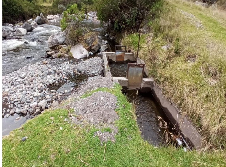
Figura 22: Zona de Captación en Pucara. Fuente: Autor.
