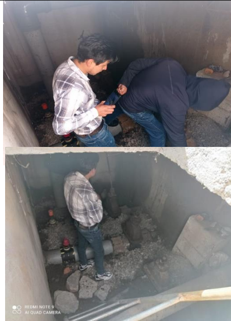
Figura 4: Levantamiento de la información en el tanque de almacenamiento Santa Rita.
