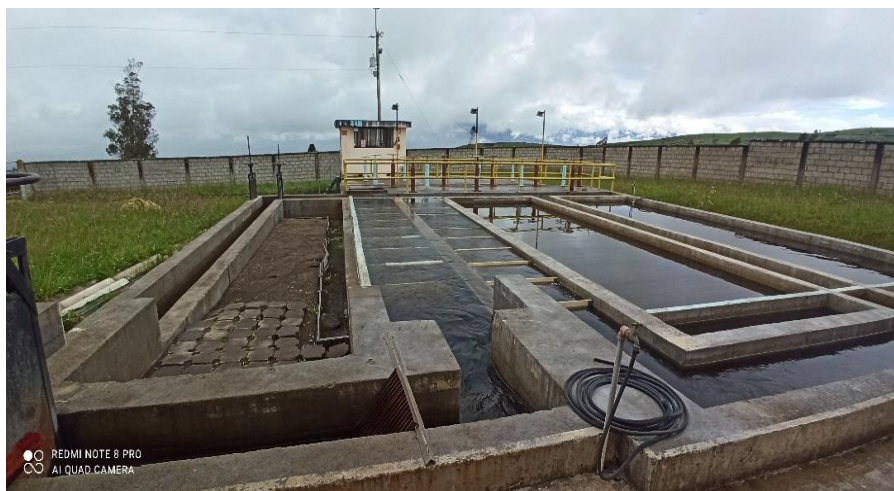
Figura 17: Planta de tratamiento de agua potable de la ciudad de Píllaro Fuente: Autor
