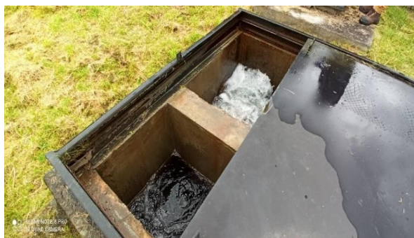
Figura 36: Tanque colector de llegada en Rocafuerte Fuente: Autor.
