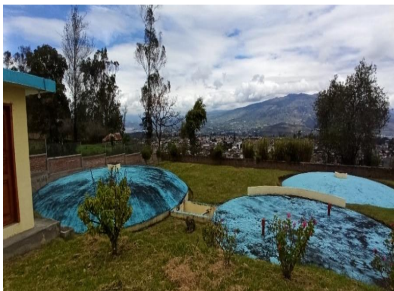
Figura 19: Tanques de almacenamiento de agua potable Rocafuerte Fuente: Autor
