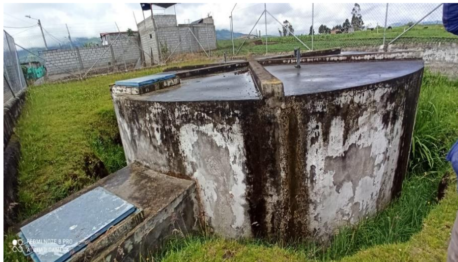
Figura 48: Tanque de almacenamiento Presidente Urbina Fuente: Autor.
