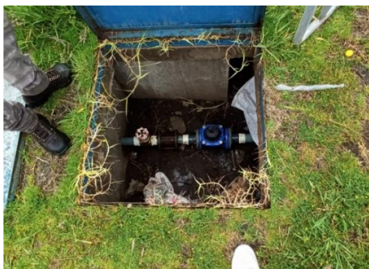
Figura 51: Tubería de entrada al TA Rocafuerte Fuente: Autor.
