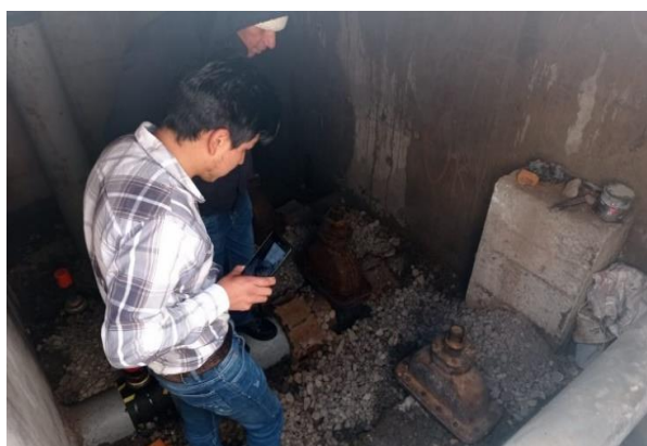
Figura 35: Tuberías de salida del tanque colector Fuente: Autor.
