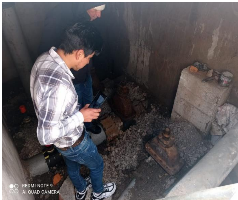
Figura 46: Tuberías de salida del TA Rocafuerte
