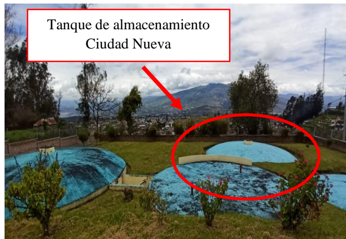
Figura 52: Tanque de almacenamiento Ciudad nueva Fuente: Autor.
