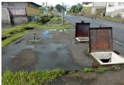
Figura 28: Tanque colector Fuente: Autor.
