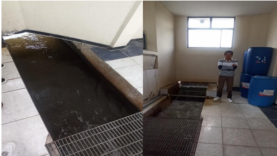
Figura 24: Medición del caudal de ingreso a la PTAP. Fuente: Autor.
