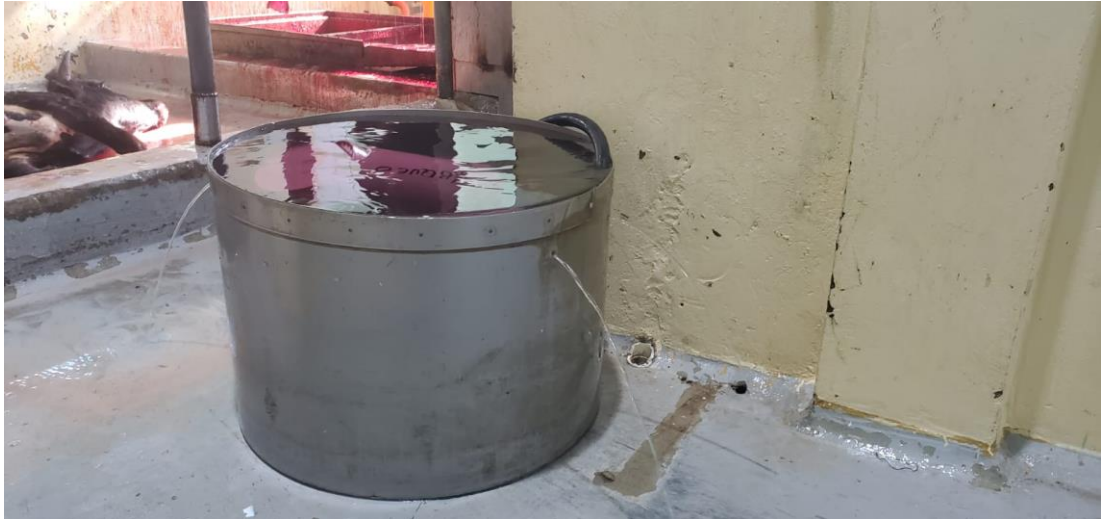
Figura 46. Contenedor de agua desbordándose.
