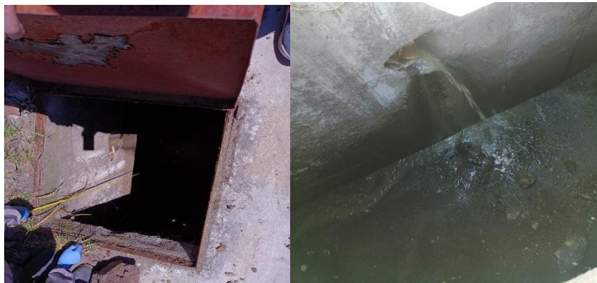
Figura 29. Tanque repartidor de la PTAR
