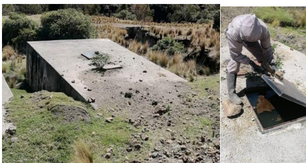
Figura 31. Lecho de secado de lodos de la PTAR
