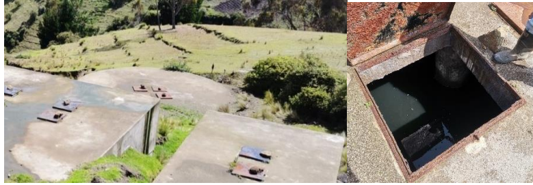
Figura 32. Filtro anaerobio de filtro ascendente de la PTAR
