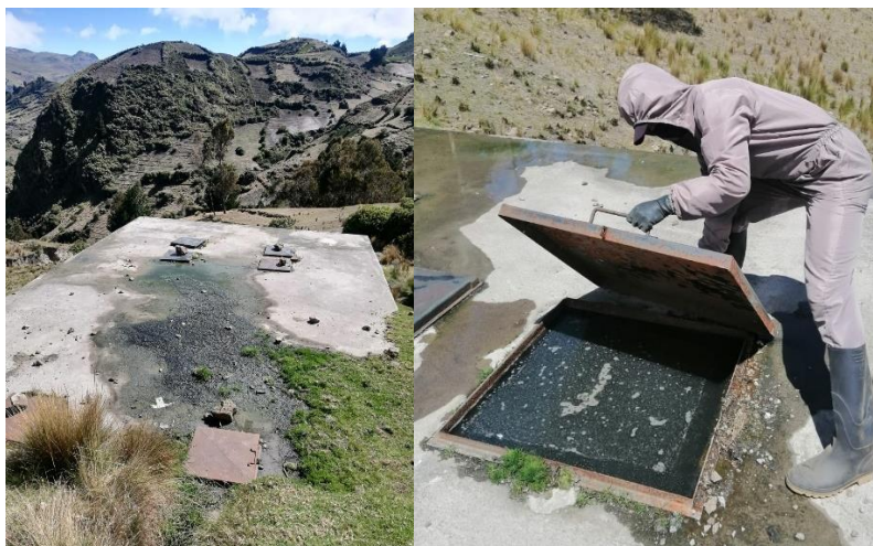
Figura 30. Tanque séptico de la PTAR
