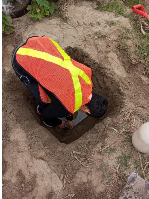
Figura 66: Preparación de la base para realizar el ensayo de densidad de campo.
