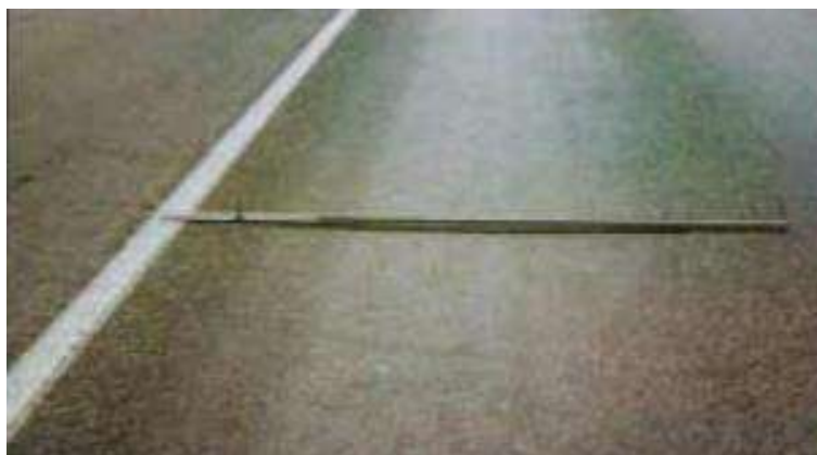
Figura N° 18: Ahuellamiento en pavimentos flexibles
