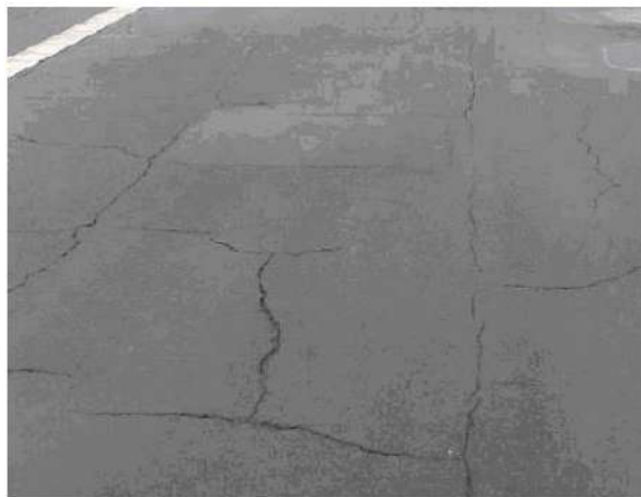
Figura N° 5: Agrietamiento en bloque en pavimentos flexibles
