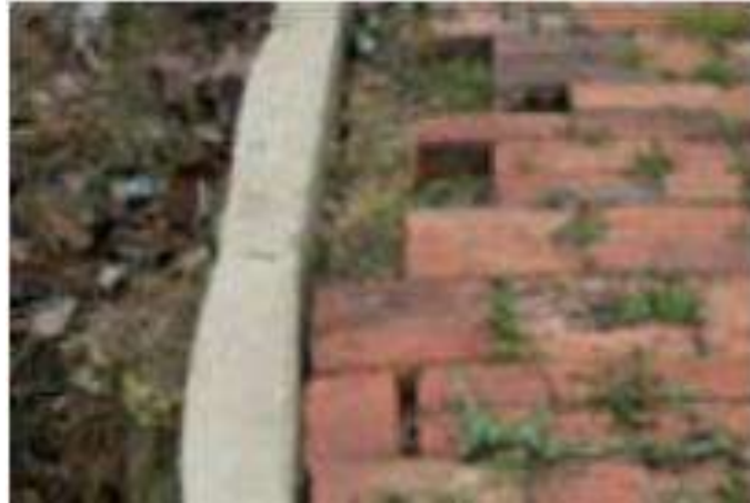
Figura N° 28: Desplazamiento de borde en pavimentos articulados
