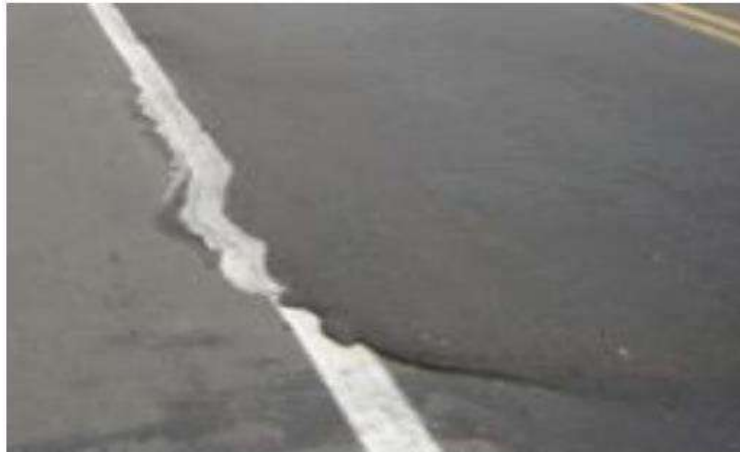
Figura N° 6: Abultamiento en pavimentos flexibles
