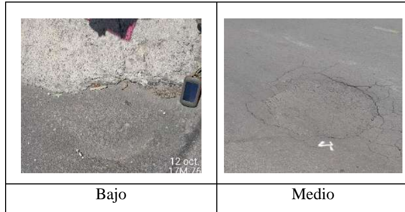
Figura N° 49: Tipos de severidades encontradas en la "Zona 28" – Abultamientos y hundimientos
