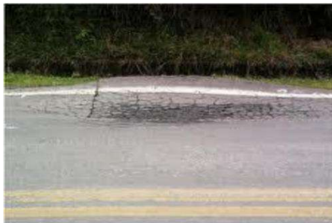
Figura N° 7: Hundimiento en pavimentos flexibles
