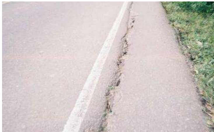
Figura N° 12: Desnivel carril / berma en pavimentos flexibles
