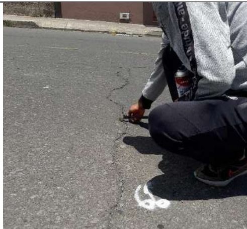
Toma de espesor de fallas
