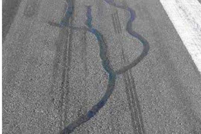
Figura N° 8: Corrugación en pavimentos flexibles
