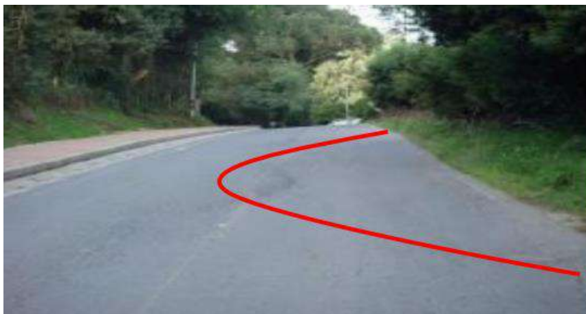
Figura N° 9: Depresión en pavimentos flexibles
