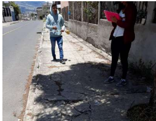
Anotación de fallas
