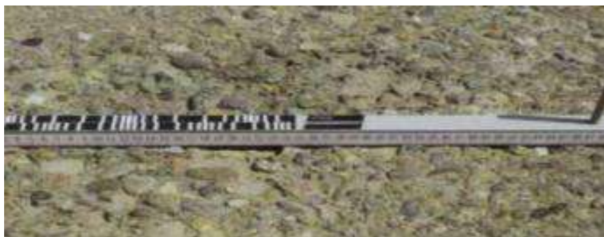
Figura N° 22: Desprendimiento de agregado en pavimentos flexibles
