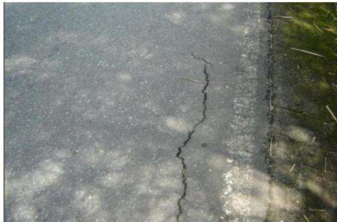
Figura N° 10: Grieta de borde en pavimentos flexibles
