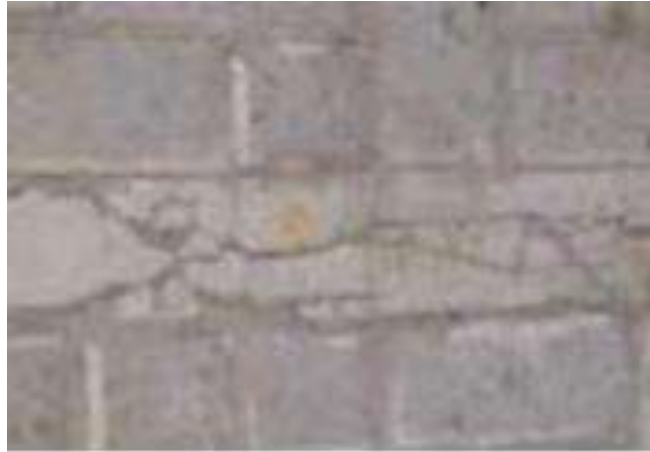
Figura N° 32: Fracturamiento de confinamientos internos en pavimentos articulados
