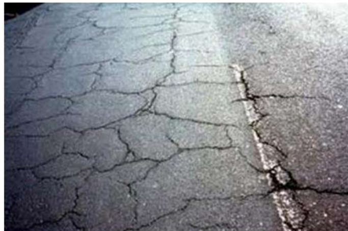
Figura N° 3: Piel de cocodrilo en pavimentos flexibles
