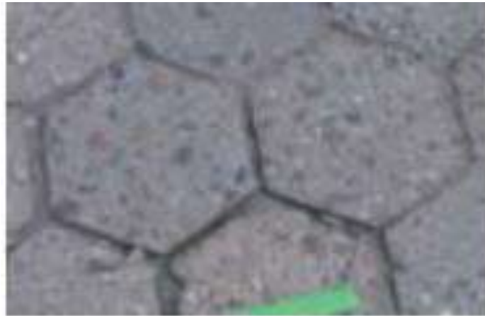
Figura N° 26: Desgaste superficial en pavimentos articulados
