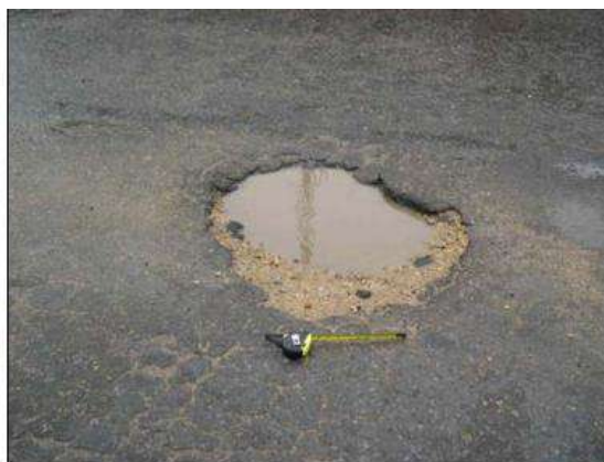
Figura N° 16: Baches en pavimentos flexibles
