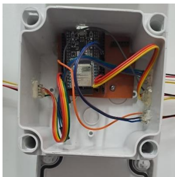
Figura 54 Instalación de circuito de ESP 32, sensores y actuadores Elaborado por: Investigador
