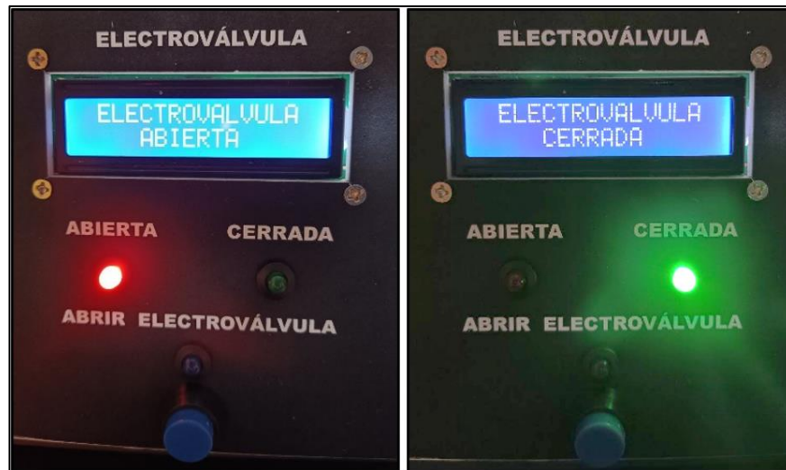
Figura 80: Estado de la electroválvula.
