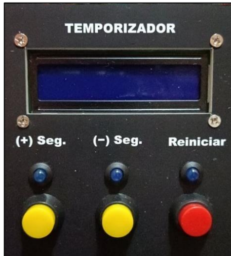
Figura 74: Estado del temporizador.
