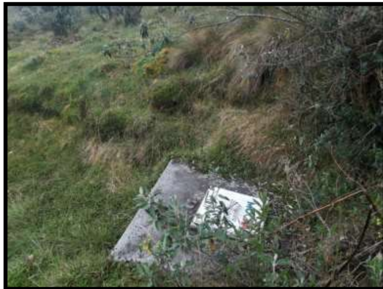
Figura 16. Captación la Vaquería
