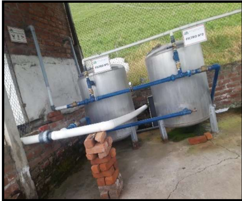
Figura 29. Tanques de filtración
