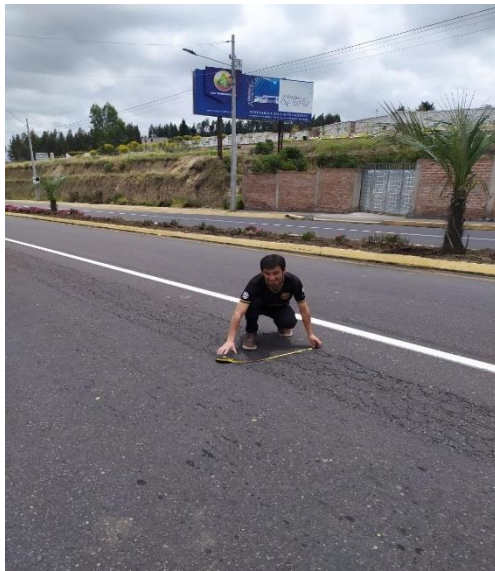
Medición de las fallas presentes en la vía (PCI)
