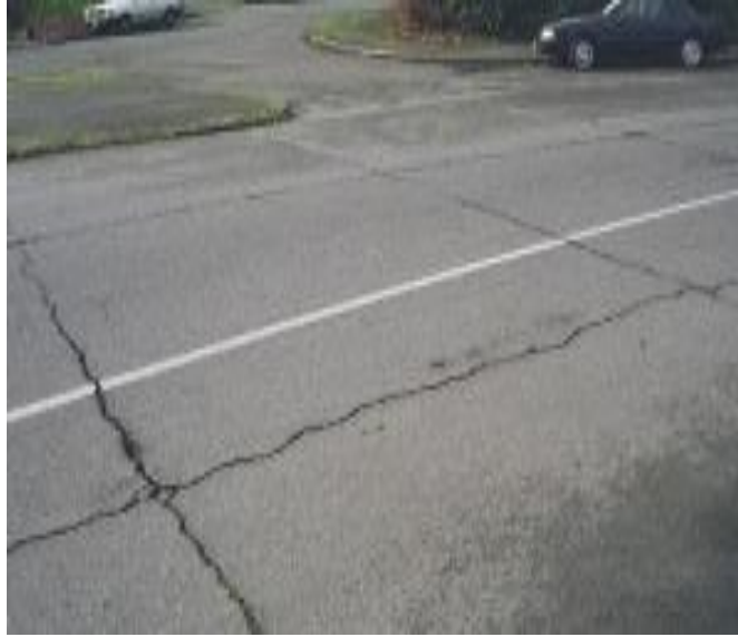
Figura1. 15 Grieta de reflexión de junta [21].
