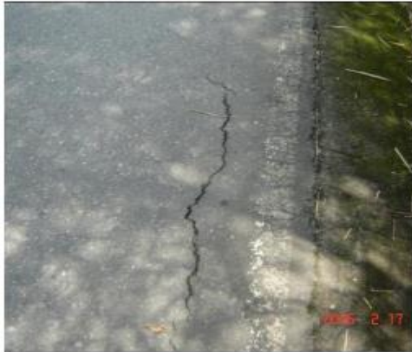
Figura 1. 9 Fisuras de Borde [27].
