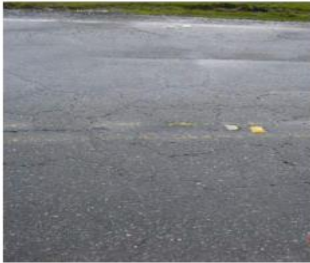
Figura 1.10 Fisuras en Bloque [27].
