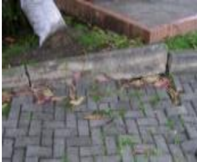
Figura 1. 38 Fracturamiento de confinamientos Externos [34].
