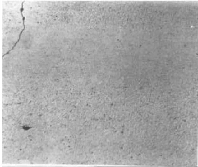
Figura 1. 27: Deformaciones de Superficie por Desprendimiento [26].
