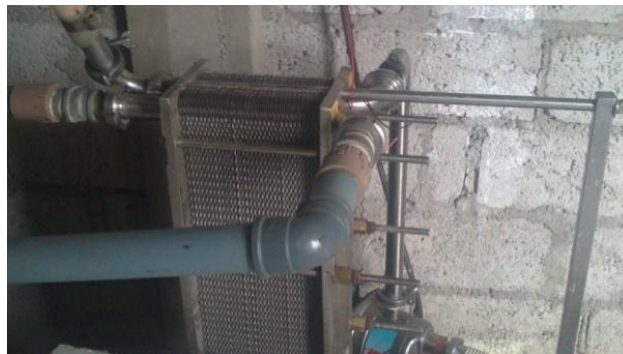
Fig. 4.2: Imagen del intercambiador de calor por placas.
