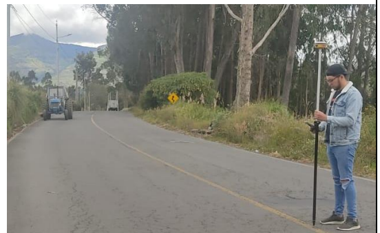
Toma de puntos tanto en el eje central y borde de la vía.
