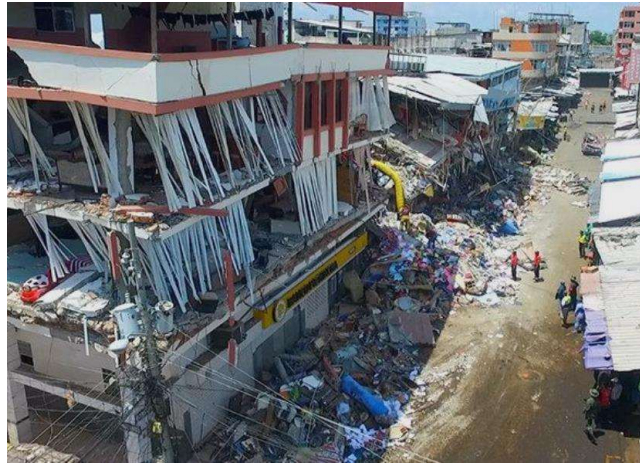
Figura 3. Colapso de estructuras en Tarqui-Manta, sismo Pedernales (2016) [7]
