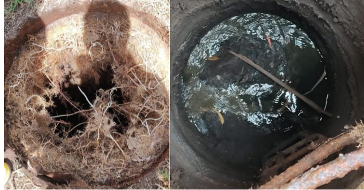
Ilustración 23.- Pozos que se Presentan una Falta de Mantenimiento y Limpieza
