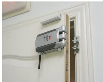
Figura 2 Control de acceso autónomo. [14]
