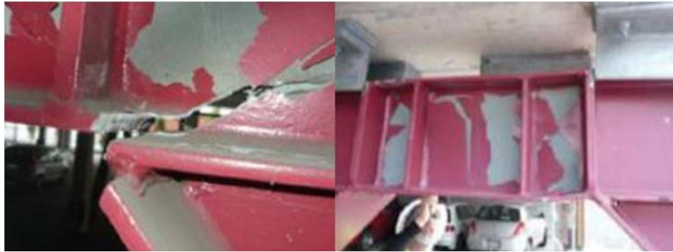
Figura 12 Rotura de enlaces de acero (Cagua et al., 2021)
