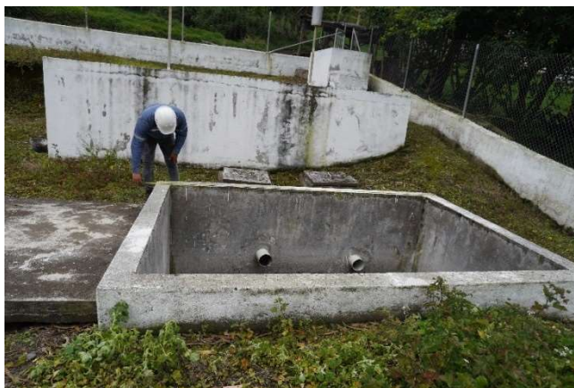
Figura 12: Medición del lecho de secado de lodos. Fuente: El Autor
