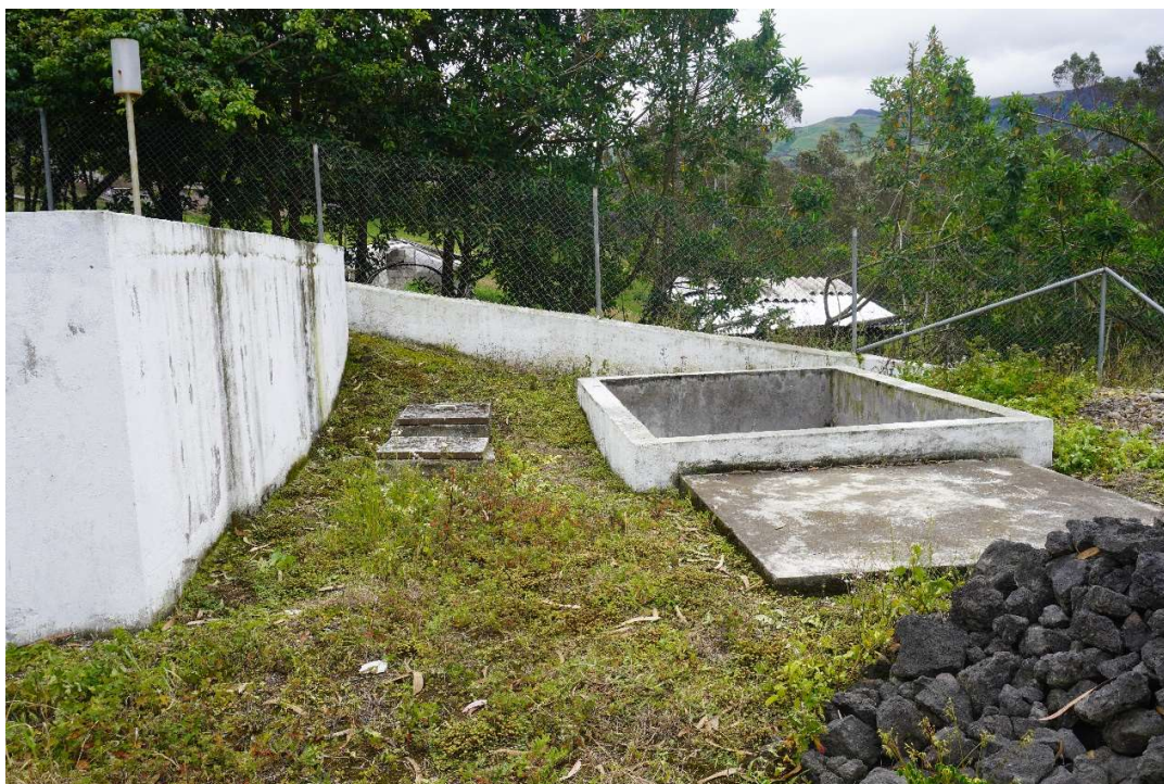
Figura 39. Lecho de secado de lodos
