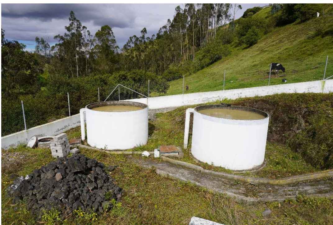
Figura 40. Tanque anaerobio de flujo ascendente (FAFA)
