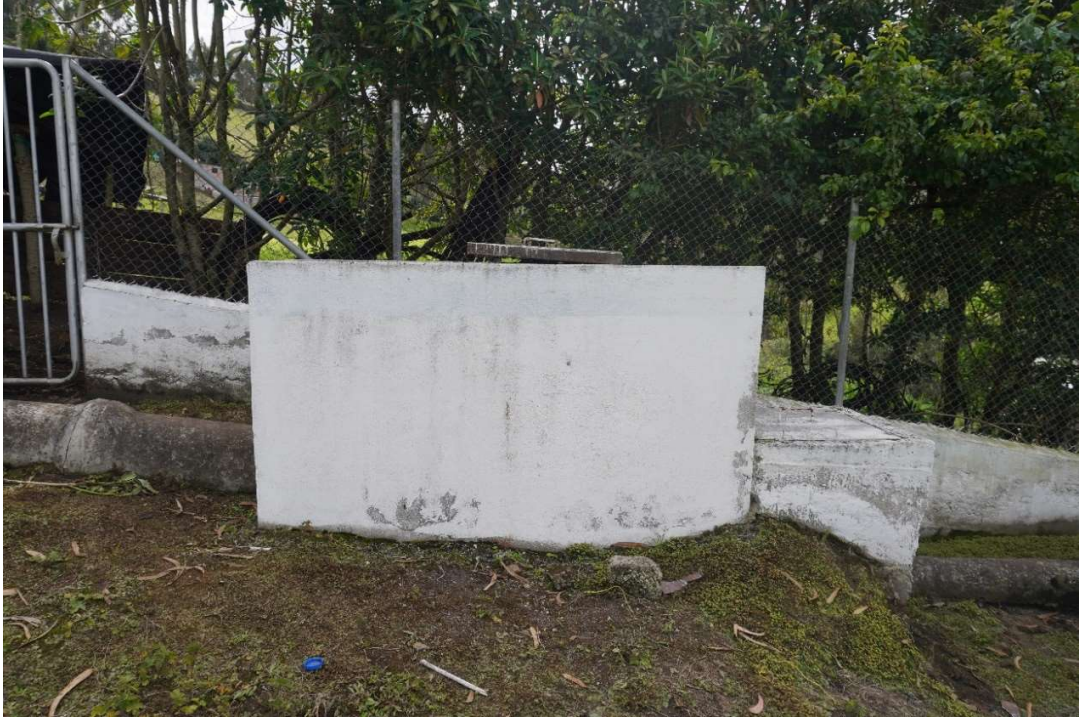
Figura 37. Tanque repartidor de Caudal
