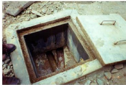
Fig. 12. Caja de Inspección Condominial de Mampostería.
